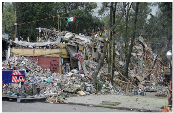
Imagen 8: Edificio 1C colapsado
