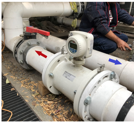
Figura 3.28: Sensor de flujo instalado en la salida de agua proveniente de las diez bombas de calor.
