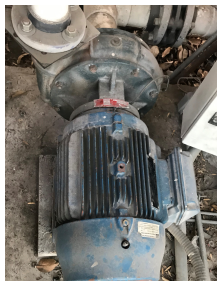
Figura 3.14: Bomba recirculadora de 15 hp para el sistema 1.
