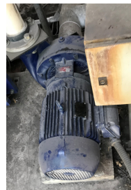
Figura 3.15: Bomba recirculadora de 10 hp para el sistema 2.
