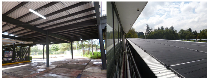
Figura 3.10: Instalación del sistema 1 en la zona del pasillo techado de la Ludoteca
