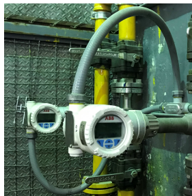
Figura 3.23: Medidores de flujo de gas de las dos calderas ubicadas en el cuarto de calderas.
