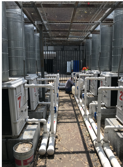
Figura 3.24: Bombas de calor instaladas en el cuarto de máquinas.
