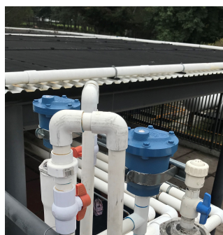
Figura 3.19: Válvula eliminadora de aire ( S_1 : válvula derecha y S_2 : válvula izquierda)
