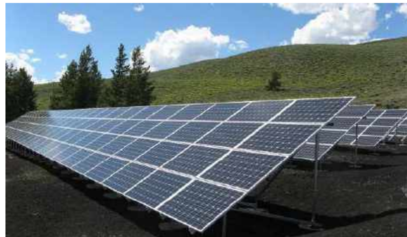
Fig. 6.26. Sistema fotovoltaico instalado.
