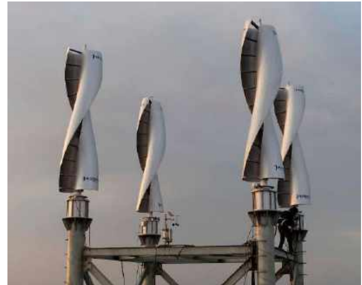
Fig. 6.2. Aerogeneradores en función.
