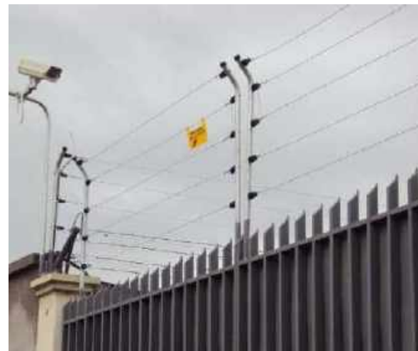
Fig. 6.32. Rejas eléctrica perimetral con anuncio y cctv. .
