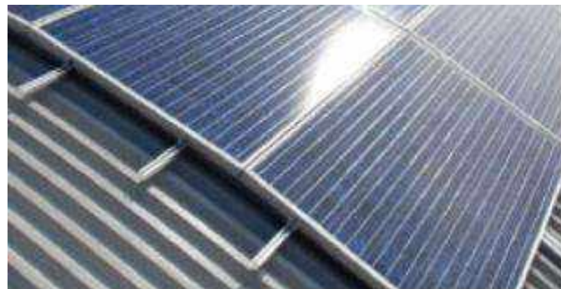
Fig. 6.27. Vista de sistema fotovoltaico.
