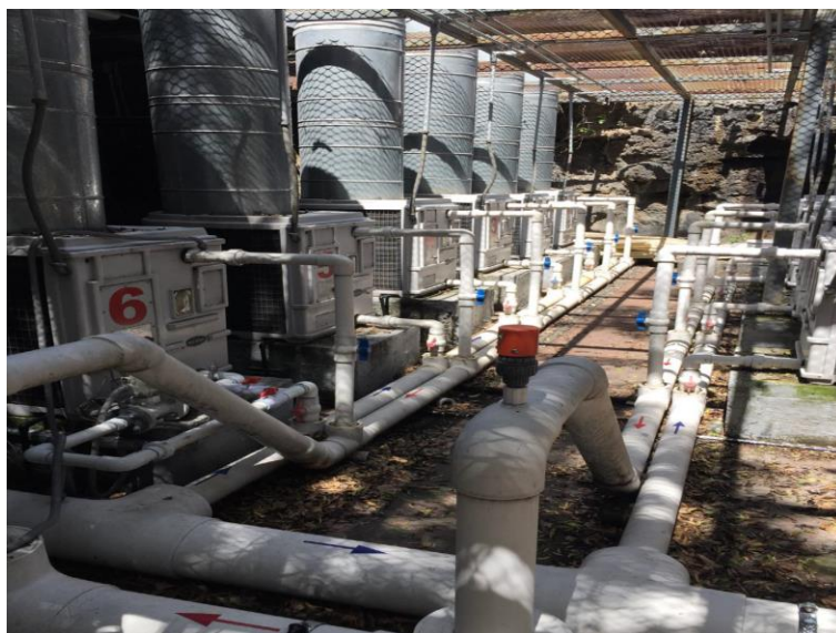
Figura 5. Foto de las bombas de calor que se encuentran a un costado de la AOU.
