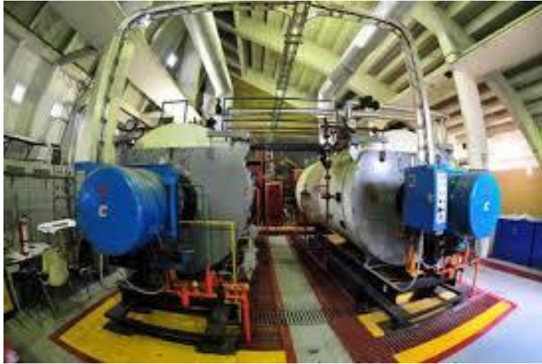
Figura 4. Foto de las dos calderas instaladas en el cuarto de máquinas.
