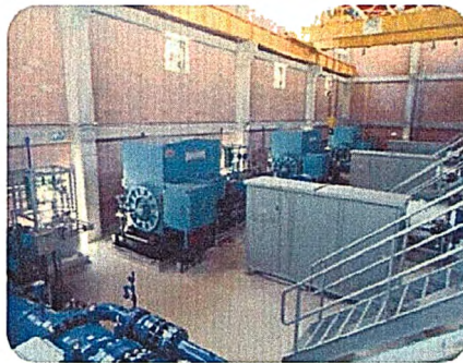
Fotografía 3. Planta de bombeo 2
