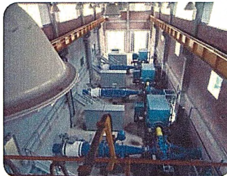
Fotografía 2. Planta de bombeo 1
