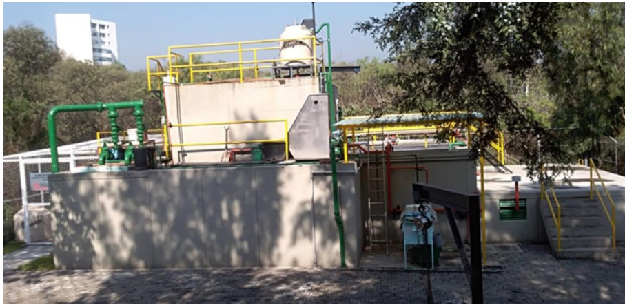
Figura 4.6. Planta de tratamiento de agua residual de la Facultad de Ciencias Políticas y Sociales.
