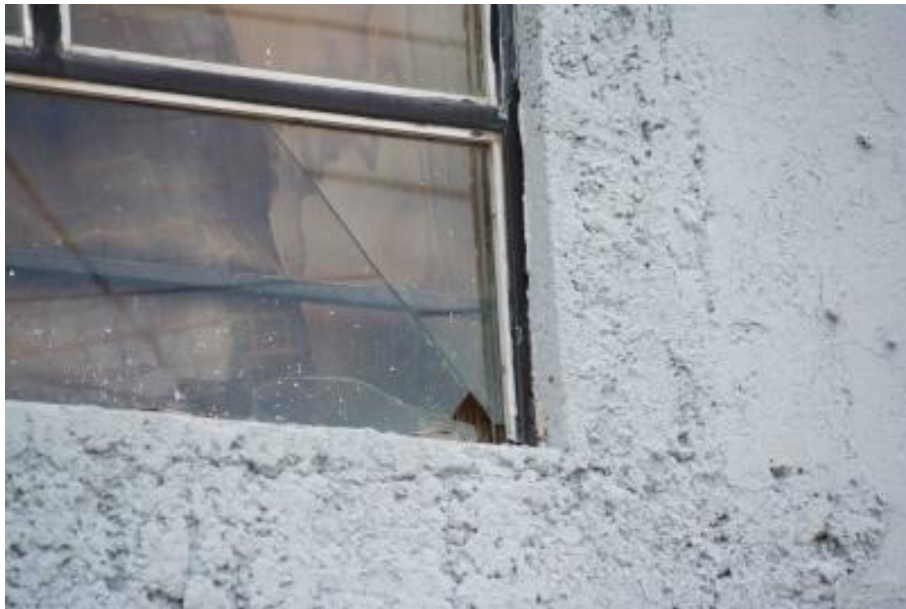
Figura 4.2 Ventana rota en una vivienda
