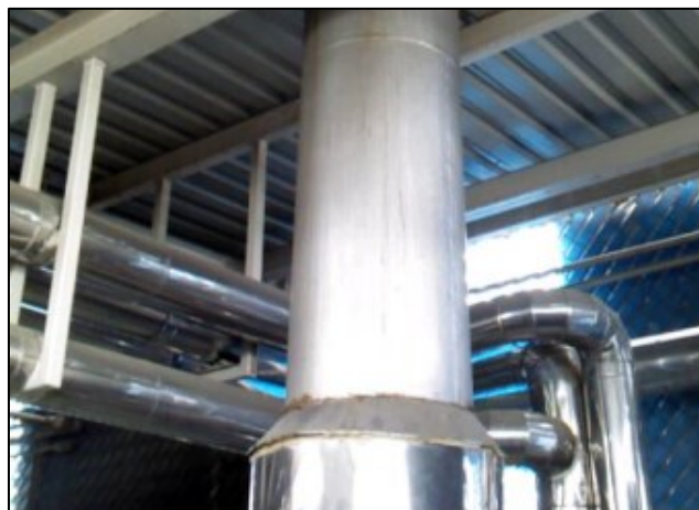
Imagen 5. Desgaste de tubería.
