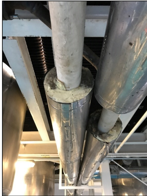
Imagen 8. Tubería sin aislante.
