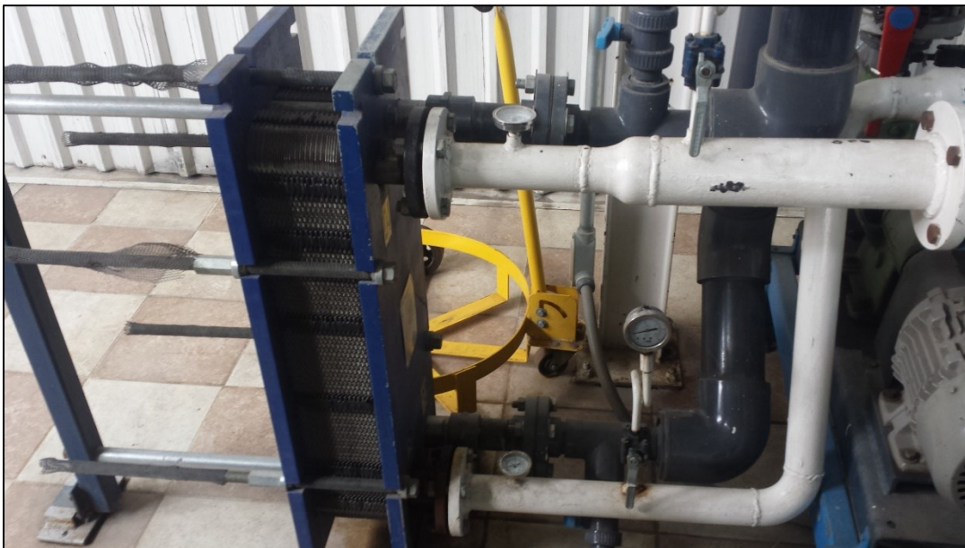
Imagen 12. Intercambiador de calor de placas de la empresa.
