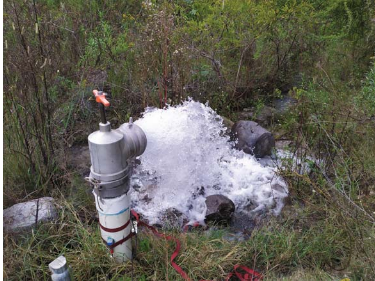
Fig. 4.7 Pozo e hidrante en operación
