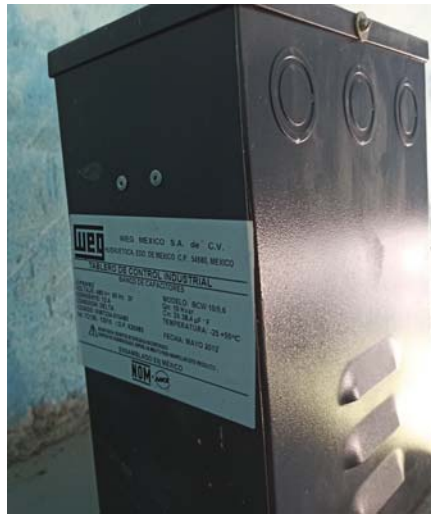
Fig. 4.4 Banco de capacitores instalado actualmente
