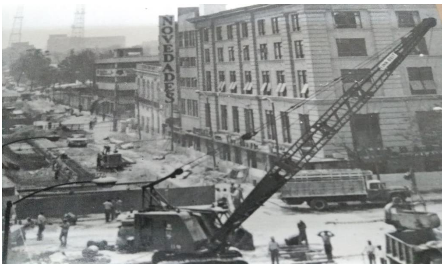
Foto 3: Obras de construcción de la Línea 1 del Metro. Imagen difundida por el STC
