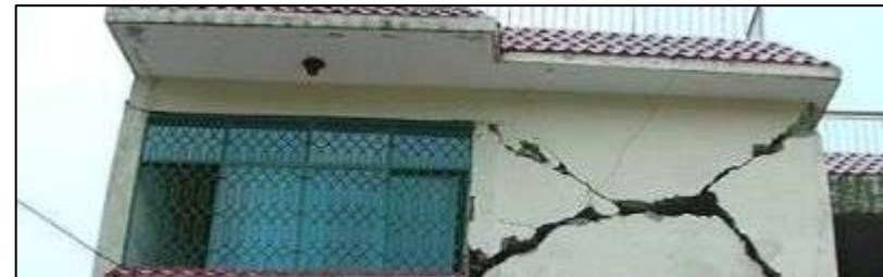
Foto 21. Tomada en sitio. Fallas por torsión. Fecha de captura: Septiembre del 2017
