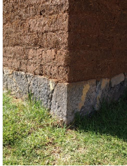
Fig. 9Detalle de materiales en construcción tipo vernácula en instalaciones de GIRA A.C. Pátzcuaro, Michoacán. Sara Navia 2018
