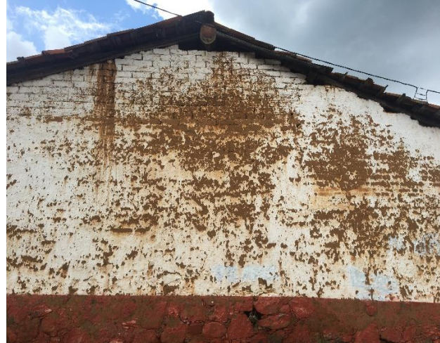
Fig. 48 Fachada de una vivienda junto a la plaza principal que muestra el deterioro de la pintura y los materiales originales.
