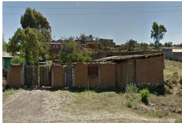
Fig. 123 Vivienda e Adobe en deterioradas condiciones
