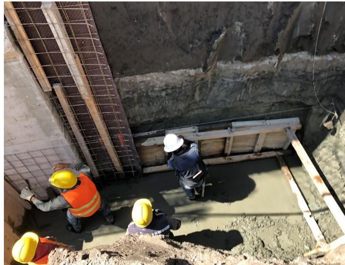
Imagen 56. Desprendimiento de tierra y colocación de tarimas.
