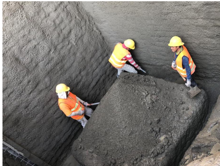
Imagen 25. Se desperdició mucho concreto.
