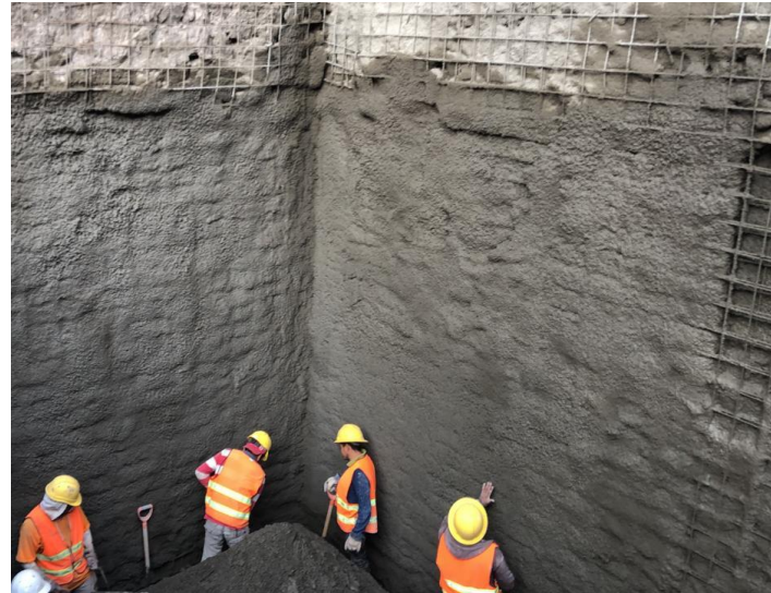
Imagen 24. Sin aprobación del concreto lanzado .
