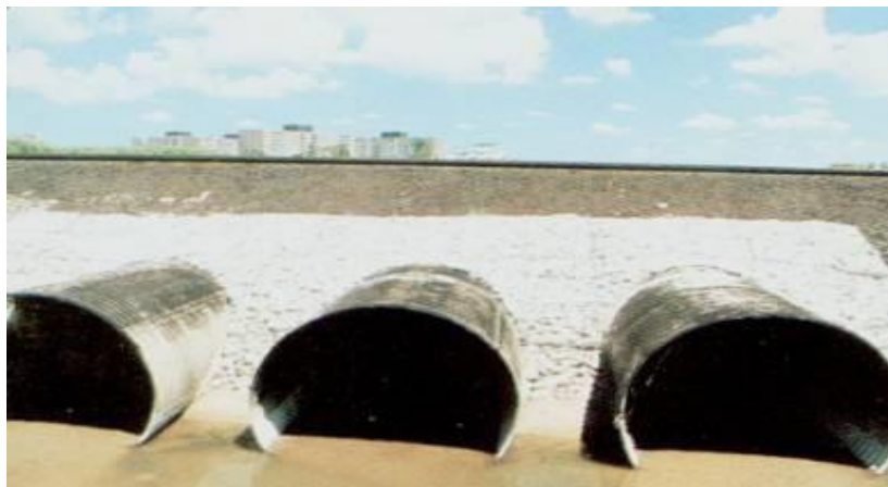
Fotografía 2.4.(j) Batería de alcantarillas abovedada Fuente: Maccaferri
