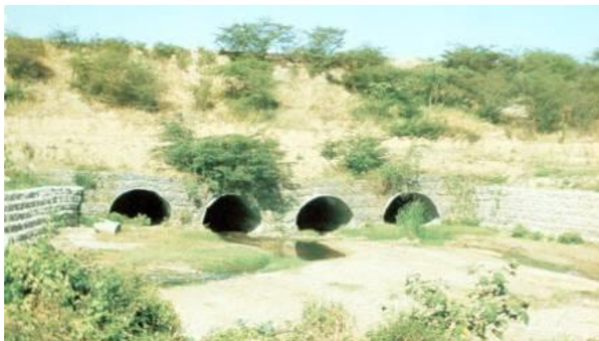
Fotografía 2.4.(i). Batería de alcantarillas abovedada Fuente: Maccaferri
