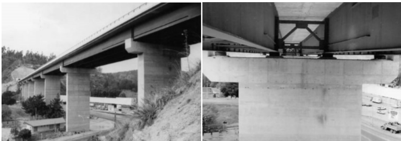
FIGURA II.28. Estructura Puente Marga-Marga. a) Vista panorámica del puente; b) aisladores instalados en conexión de superestructura con columnas del puente (Boroschek, et al. , 2003).
