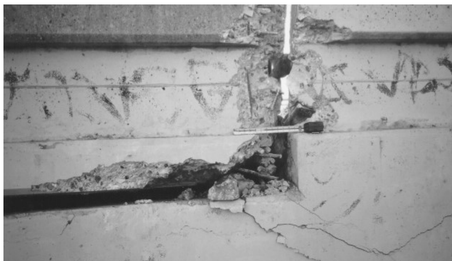
FIGURA II.14. Estribo del Puente Río Santa Clara dañado por el golpeteo originado en el sismo de Northridge en 1994 (Wai-Fah & Lian, 2003).
