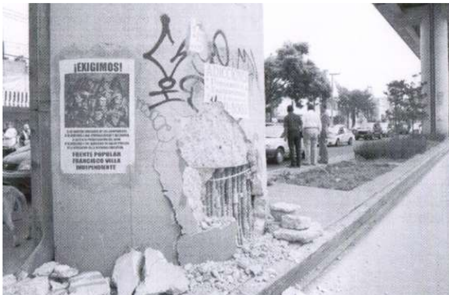
FIGURA II.20. Daños por flexocompresión en columnas de puentes durante el sismo de Axochiapan, 19-sep-17, M_w = 7.1 (El Universal, 2017).
