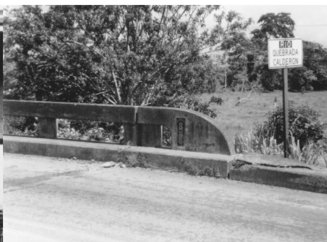
FIGURA II.27. Asentamiento de estribo del Puente Rio Quebrada Calderón durante el sismo 1991 en Costa Rica (Wai-Fah & Lian, 2003).
