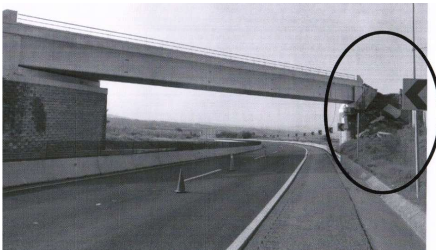
FIGURA II.25. Falla en terraplenes de acceso, tierra mecánicamente estabilizada, en puentes de Morelos, durante el sismo del 19-sep-2017, M_w = 7.1 .
