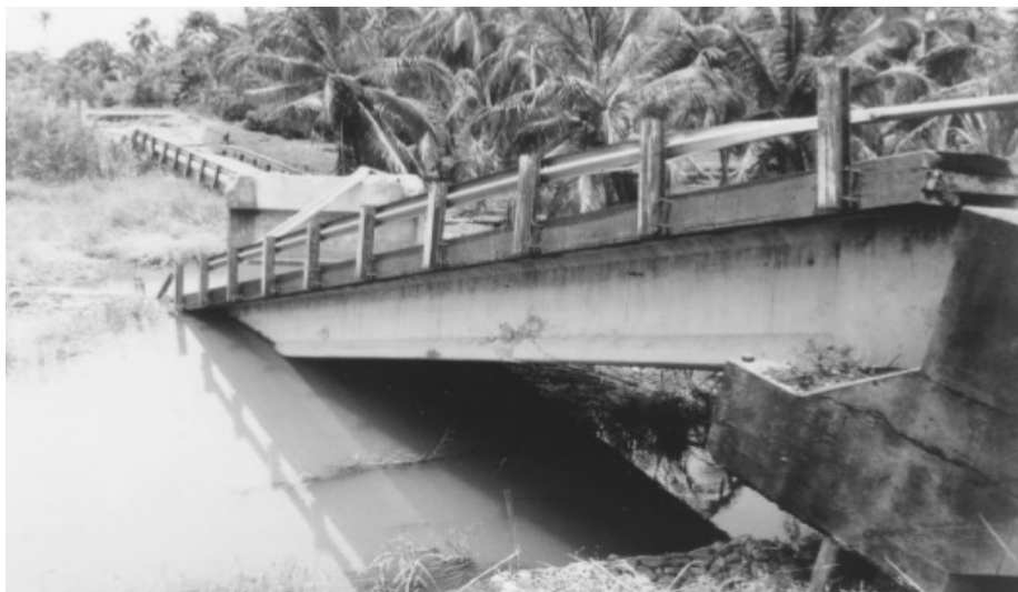
FIGURA II.13. Colapso del Puente Río Bananito en el terremoto de 1991 en Costa Rica (Wai-Fah & Lian, 2003).
