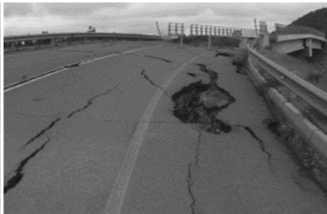
FIGURA II.23. Falla en estribo del Puente Nivel Graneros sobre Ruta 5 (Schexnayder, et al., 2014).
