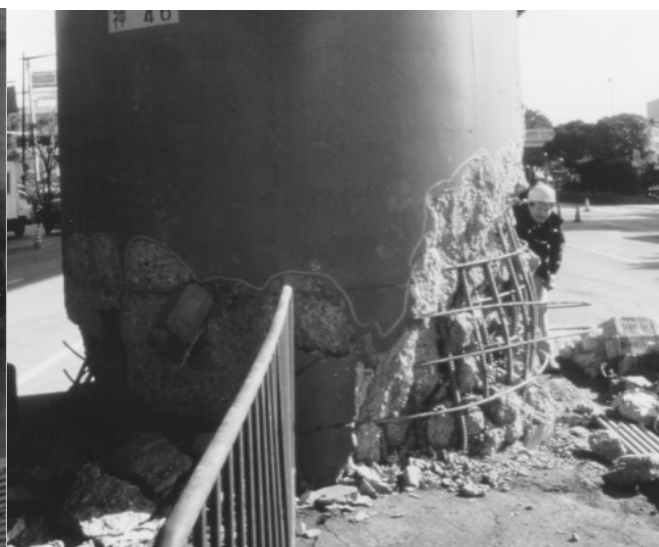
FIGURA II.19. Daño en pila del Hanshin Expressway durante el sismo de 1995 en Hyogo-Ken Nanbu (Wai-Fah & Lian, 2003).
