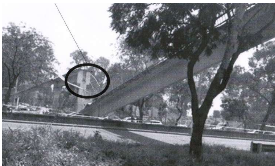
FIGURA II.12. Pérdida de apoyo en puente peatonal, Periférico Sur, CDMX (Zavala, 2017).
