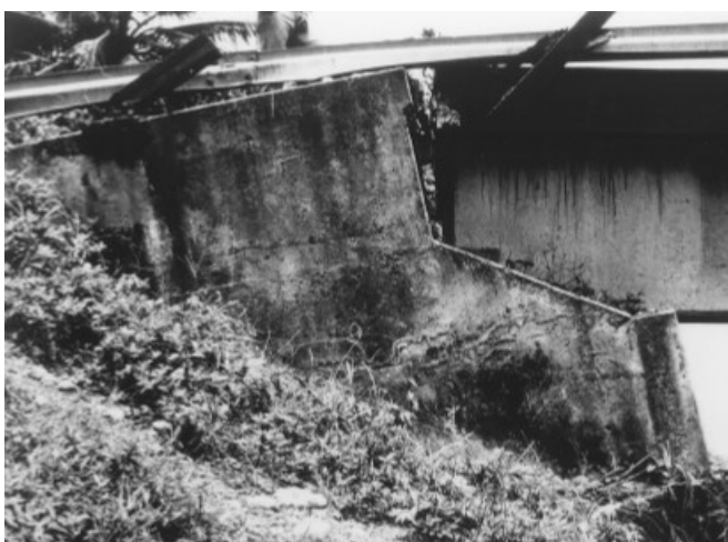
FIGURA II.26. Estribo de puente dañado durante el sismo de 1991 en Costa Rica (Wai-Fah & Lian, 2003).
