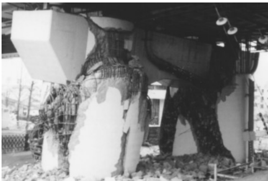
FIGURA II.21. Falla de marco de 2 columnas en el sismo de 1995 en Hyogo-Ken Nanbu (Wai-Fah & Lian, 2003).
