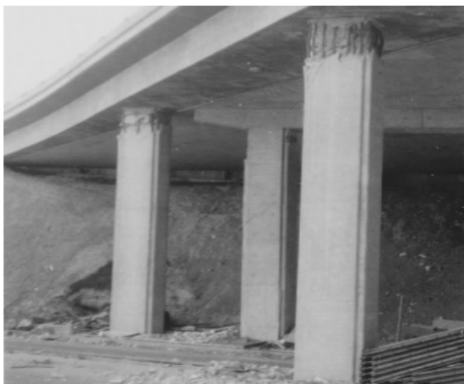
FIGURA II.18. Daño a paso carretero en San Fernando durante el sismo de 1971 (Wai-Fah & Lian, 2003).
