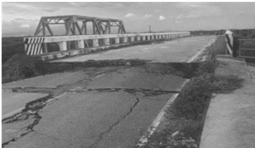
FIGURA II.24. Daños en estribo, tierra mecánicamente estabilizada, del Puente El Estero, durante el sismo del 7-sep-2017, M_w = 8.2 (Aguado, 2017).
