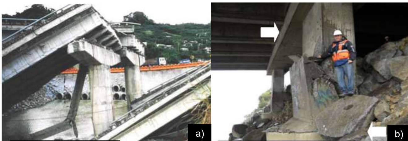
FIGURA II.10. Casos de daño estructural debido a fallas en el suelo de apoyo. a) Taiwán, 1991; b) Chile, 2010 (Marsh, et al., 2014).
