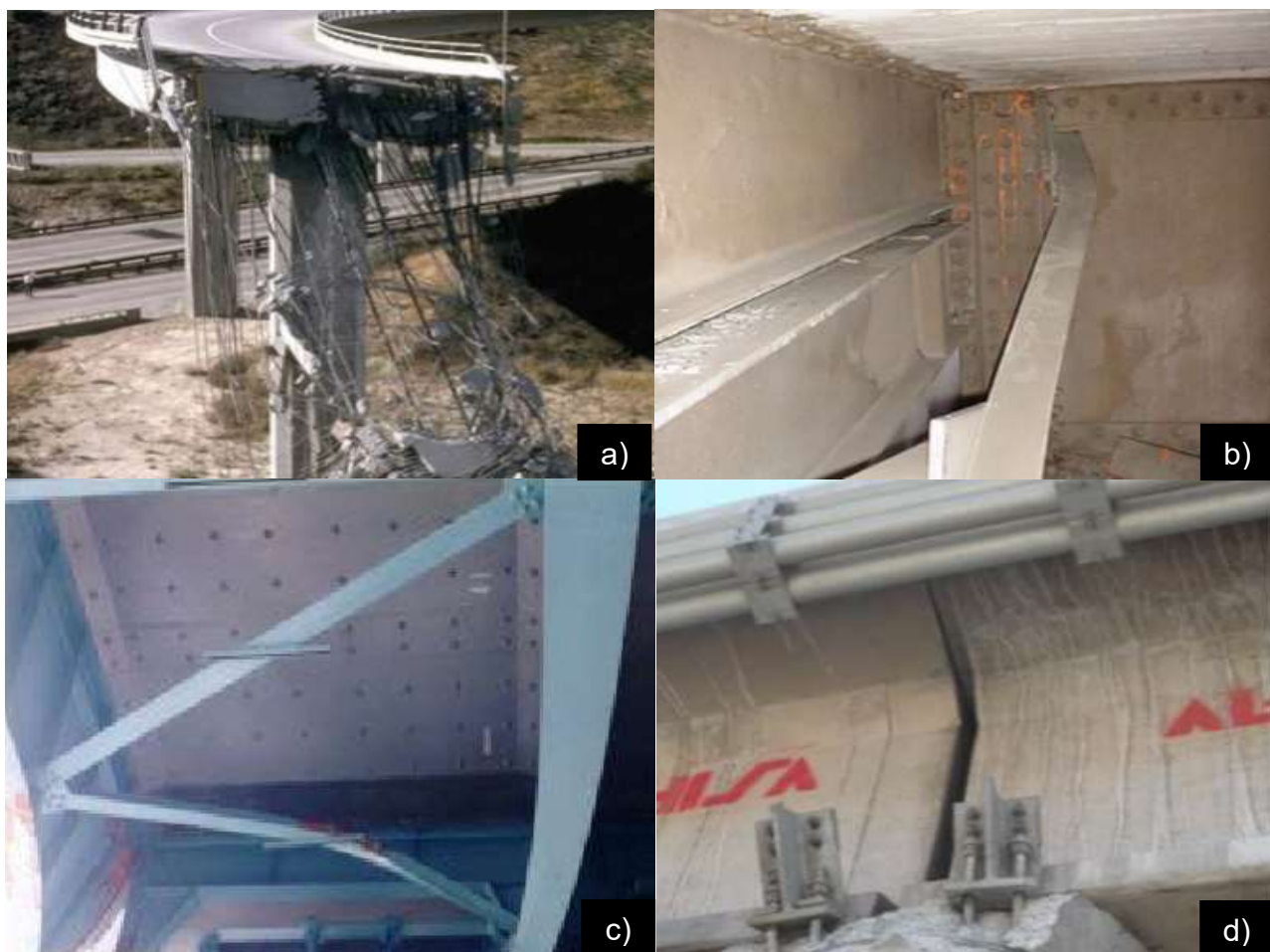
FIGURA II.9. Daños típicos en cubiertas irregulares en planta de puentes. a) Northridge, 1994; b) Nisqually, 2001; c) Kobe, 1995; d) Chile, 2010 (Marsh, et al., 2014).
