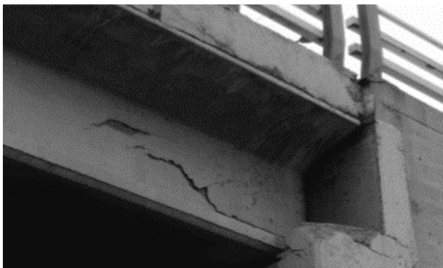
FIGURA II.17. Viga dañada por cortante ocasionado por restricción lateral de movimiento de llave de corte de concreto (Schexnayder, et al., 2014).
