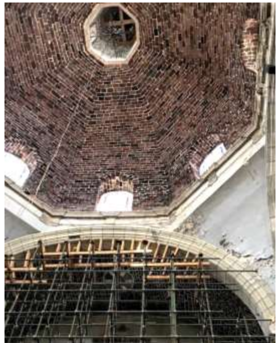
Apuntalamiento de arco toral izquierdo, puede observarse desprendimiento de aplanado y fisuras en pechina.
