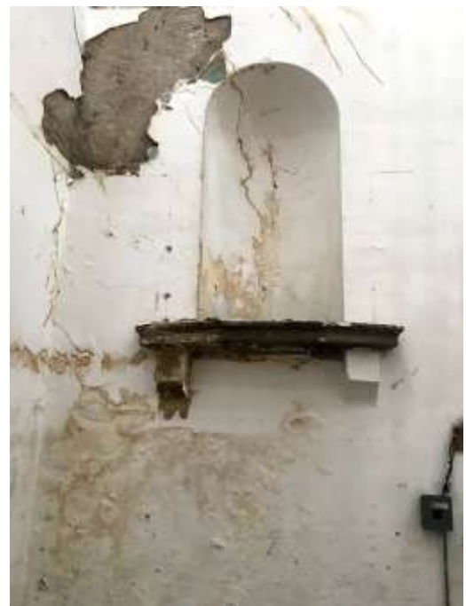
Humedad, grietas y desprendimiento de aplanado en muro interior de fachada oriente
