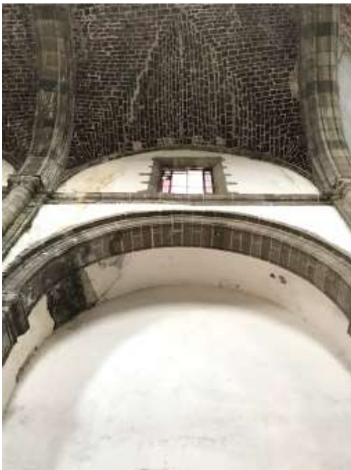
Humedad y grietas descendentes de la bóveda hacia muro y arco lateral, eje H
