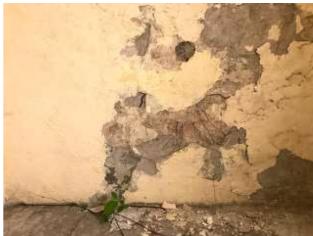
Humedad y fisuras provocadas por flora parásita invasora en la parte del salón anexo del coro, eje J tramo 9-10
