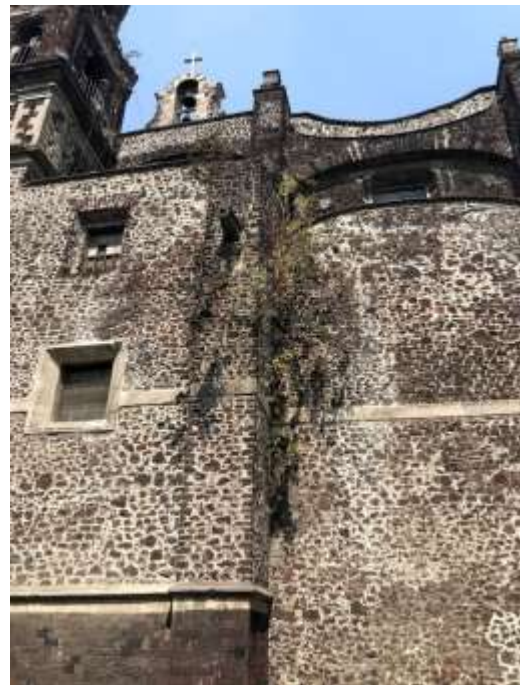
6 Daños de flora parásita en contrafuerte ubicado en fachada lateral. Vista desde calle República de Nicaragua.
