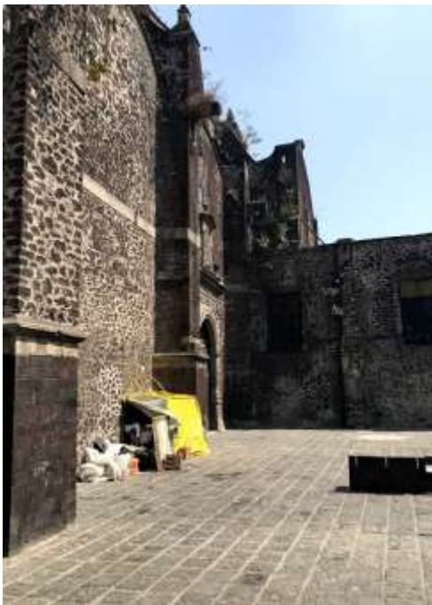
Invasión de flora parásita en fachada lateral sur e invasión de población indigente
