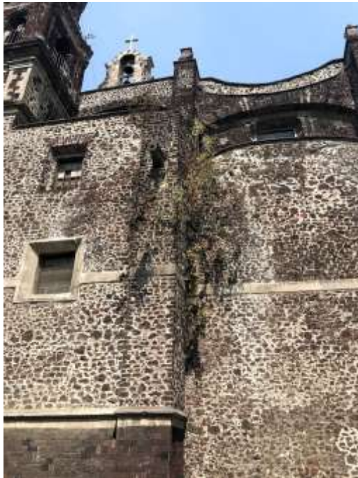
Invasión de flora parásita en contrafuerte localizado en el eje 9, fachada sur
