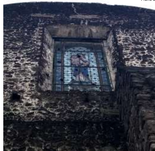
Vitral fragmentado en fachada norte, entre eje 3-4 ubicado en el transepto izquierdo dañado debido a vandalismo
