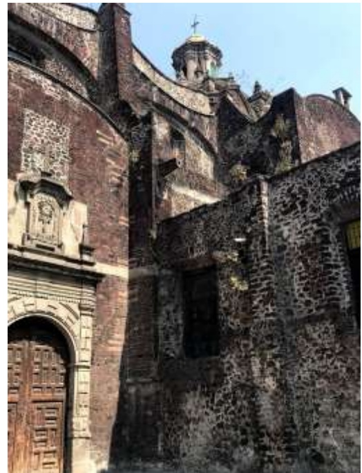
Daño en puerta de acceso lateral sur e invasión de flora parásita
