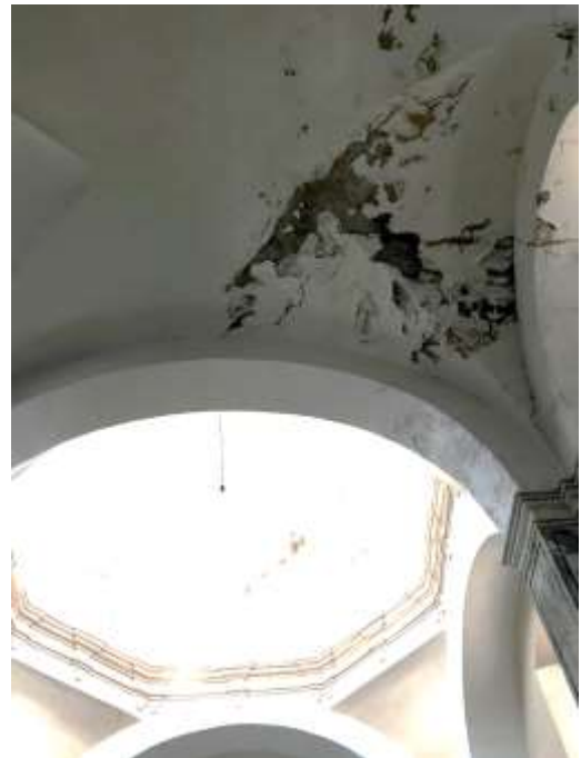
Humedad descendente y grietas localizadas en la pechina derecha, eje 8 tramo B de la capilla denominada "Sangre de Cristo"
