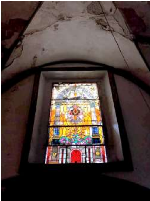
Humedad y grietas descendentes de la bóveda hacia muro en capilla lateral
