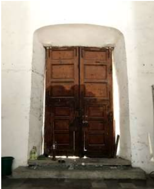
Daños en puerta de acceso lateral sur debidos a humedad, exposición solar y vandalismo
