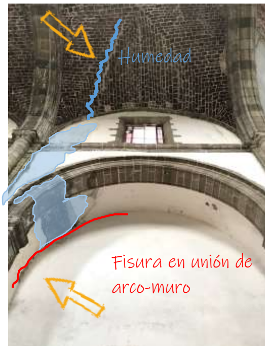
Humedad y grietas descendentes de la bóveda hacia muro y arco lateral, eje H
