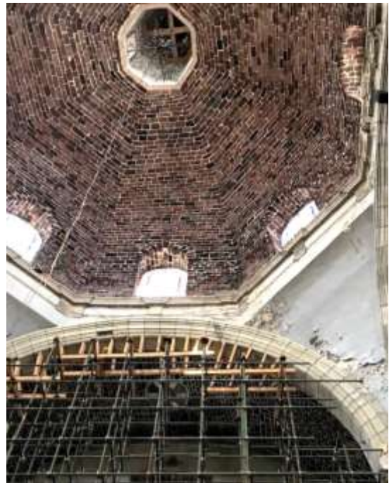
IV Apuntalamiento de arco toral izquierdo, puede observarse desprendimiento de aplanado y fisuras en pechina.
