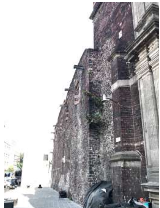
Invasión de flora parásita en fachada principal y población indigente.
