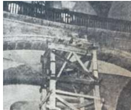
Imagen 1.1 Apuntalamiento en Arco del Coro por daños (1950)
