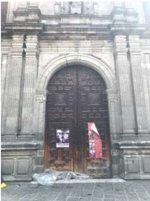
Daño en puerta principal por humedad, exposición solar y vandalismo
