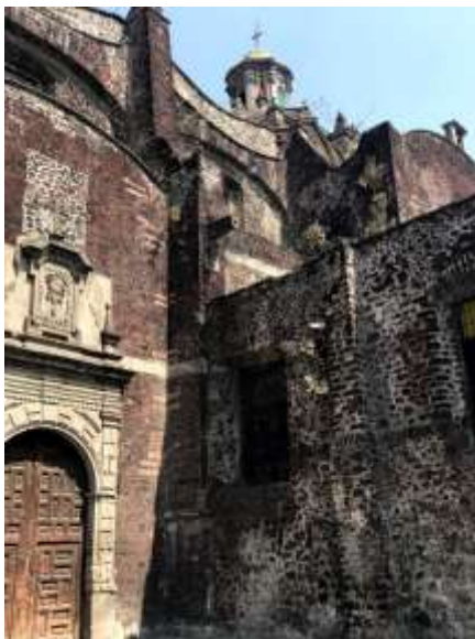
7 Fachada lateral dañada por vegetación parásita y puerta de acceso dañada por humedad, exposición solar y vandalismo. Vista desde Calle República de Nicaragua
