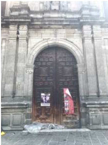
3 Puerta principal dañada por humedad, exposición solar y vandalismo.
