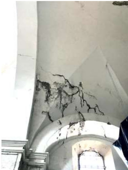
Humedad descendente y grietas localizadas en la pechina derecha, eje 8 tramo C de la capilla denominada "Sangre de Cristo"
