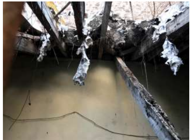
Colapso total de vigas y cubierta en anexo de sacristía principal. Tramo localizado en eje D-F tramo 3-4
