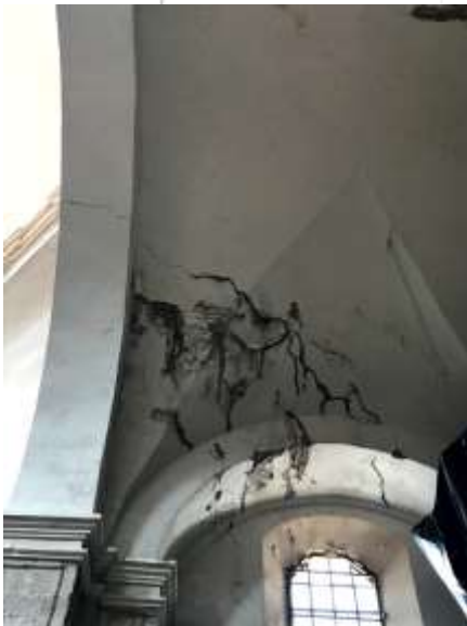
V Daños en pechina de cúpula ubicada en la capilla lateral izquierda sobre calle República de Brasil.
