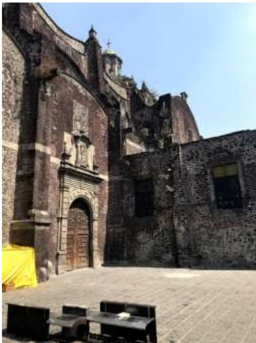
5 Fachada lateral del Templo. Se observa mobiliario urbano en mal estado, vegetación parásita y construcciones temporales de gente indigente. Vista desde Calle República de Nicaragua
