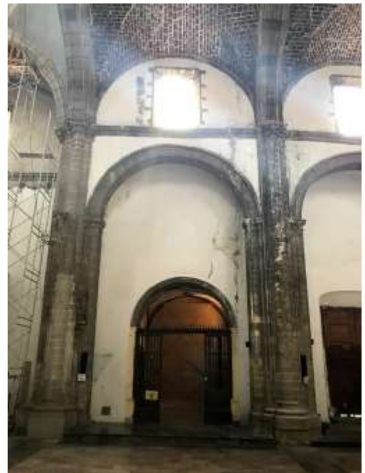
Humedad y grietas descendentes de muro lateral hacia columna y arco, eje H
