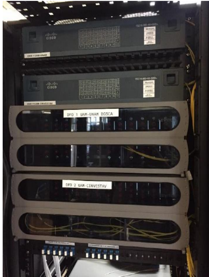
Figura 2.1: Panel de distribución de Fibra Óptica.
