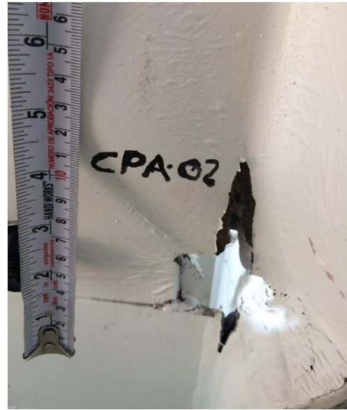
(b) Acercamiento de la grieta
