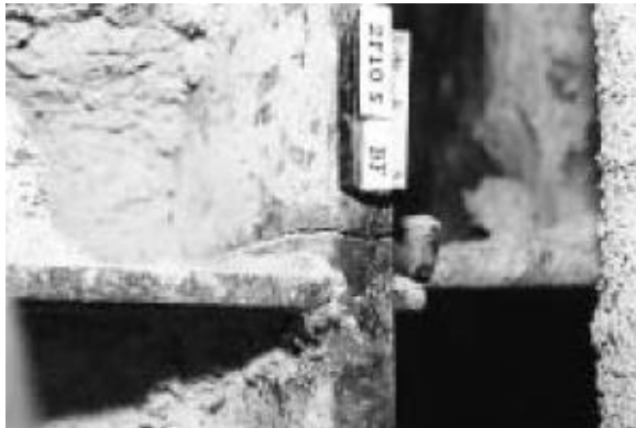
(a) Falla a través del patín de la columna
