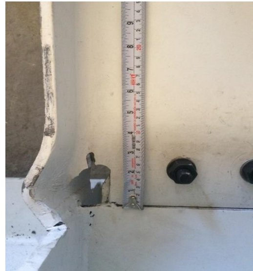
(b) Concentración de daño
