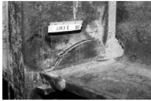
(b) Falla tipo “divot” o “nugget” en el patín de la columna
