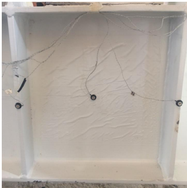
Figura 4.50. Vista de la deformación en la zona del panel
