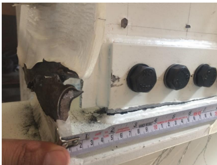
Figura 4.49. Vista de la fractura del patín
