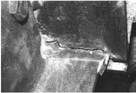
(a) Falla en la zona de fusión
