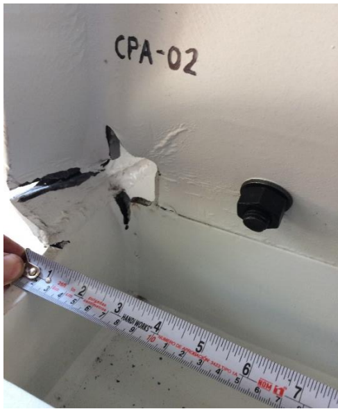
(a) Fractura parcial del patín
