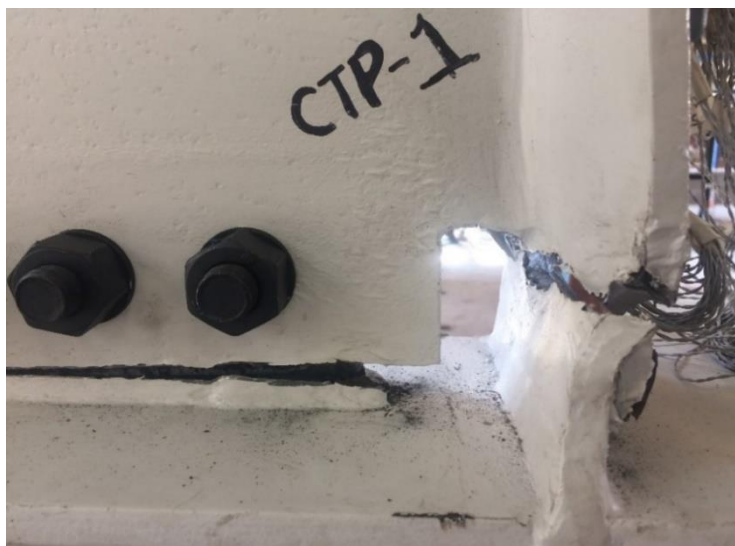
Figura 4.48. Vista lateral de la fractura de la soldadura
