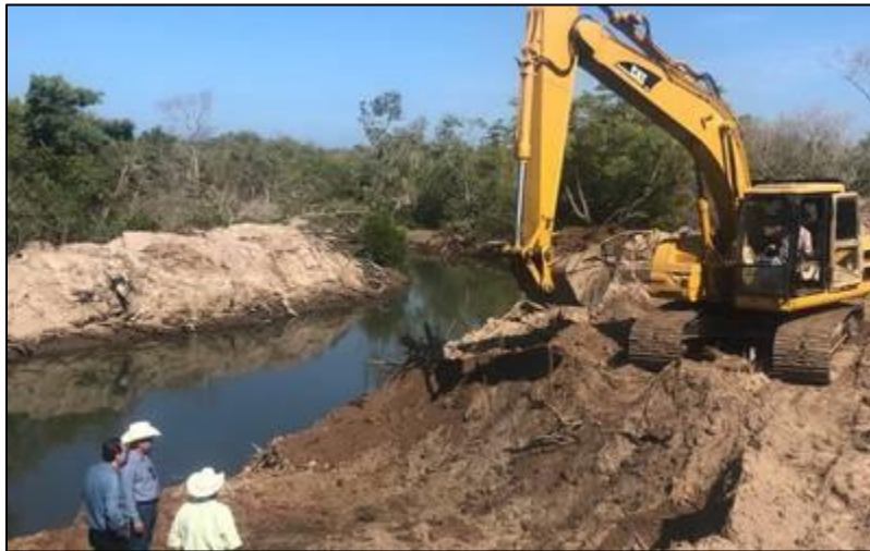
Fotografía 9. Dragado de canal alimentador hacia la Laguna del Huizache, en el sur de Sinaloa
