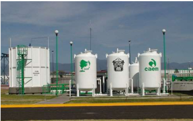
Foto 6. Planta de Recarga Artificial Toluca – Norte.
