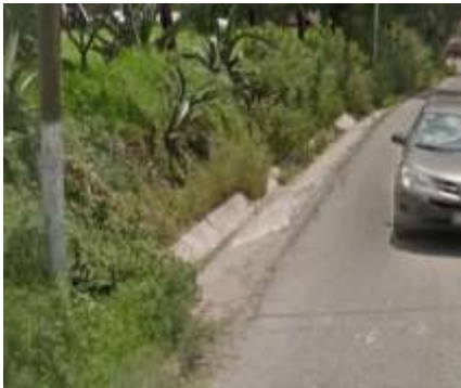
Foto 9. Obstrucción del paso del agua pluvial sobre cunetas
