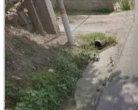
Foto 10. Secciones entubadas obstruidas
