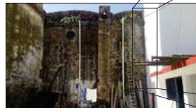
Foto 13. La fractura que aparece en la fachada oriente se aprecia también en el lado oriente, este lado fue trabajado con piedra para cubrir el hueco. También se aprecia el refuerzo para abstrair la iglesia debajo de la bajada de aguas de PVC del lado derecho.
