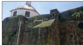
Foto 11. Vista del lateral norte del templo, la humedad por escorrente de agua de lluvia debido al taponamiento de las gárgolas y bajadas de agua ha provocado la aparición de flora y microflora así como líquenes y hongos en gran parte del muro y los contrafuertes.
