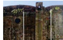
Foto 1 La falta en la base de aguas he hecho que el agua de lluvia escorra por los muros y ha creado moho, líquenes y plantas parásitas en las repisas formadas por las cabezas de los muros
