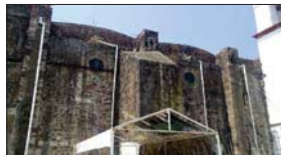
Foto 12. El perfil metálico que aparece sirvió en su momento para contener el movimiento del muro cuando apareció la fractura que se ve debajo del óculo.
