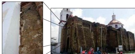
Foto 9. Vista desde el acceso Sur, desde este punto se aprecia la fractura entre la fachada y el campanario provocado por el asentamiento de este último.
