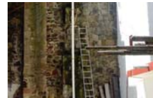
Foto 2 Al centro se ven las resaca de un elemento vertical no identificado sobre el cual se pasa una bajada de PVC de 4"
