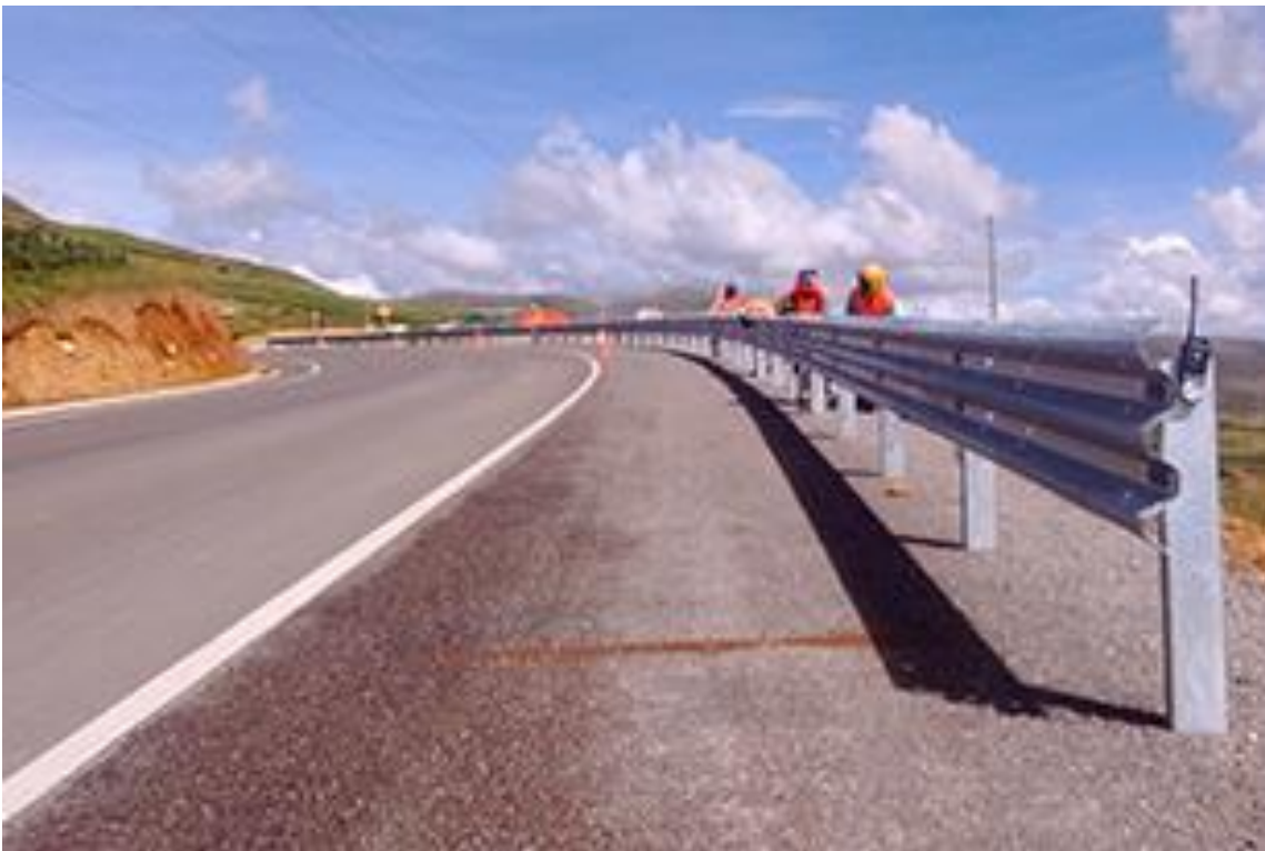
Figura 1. Vista frontal de barreras de contención.
