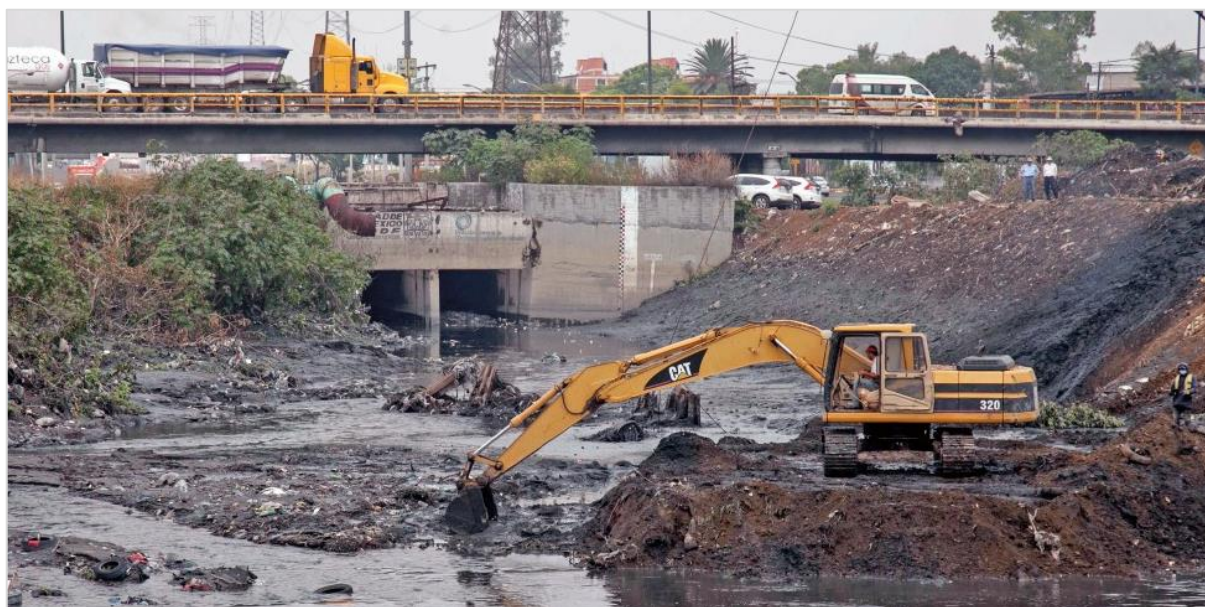
Fig.24. Barrera, M. (2018) Reforzaran en Gran Canal para evitar desbordamiento . El Universal [Fotografía]. Recuperado de https://www.eluniversal.com.mx/metropoli/edomex/reforzaran-el-gran-canal-para-evitar-desbordamiento
