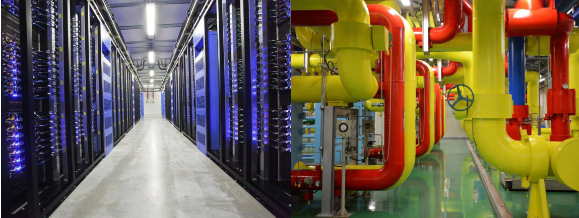
Figura 1.5: (izquierdo) vemos la sala de servidores de Facebook en la ciudad de Lulea, Suecia. Los centros de datos ahora consumen alrededor del 3 por ciento del suministro mundial de electricidad. (derecho) Vemos parte de las instalaciones del centro de datos de Google en Taiwán, imágenes tomadas de [9].
