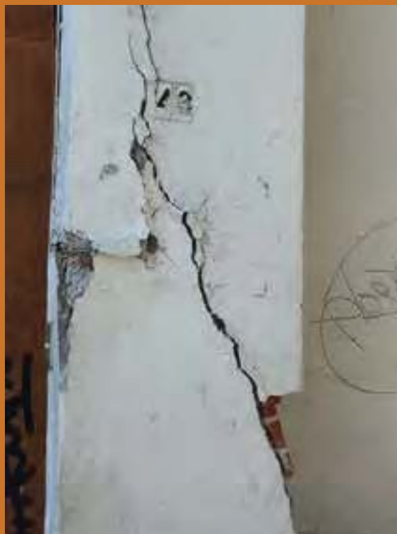
Mabel Larrechart , Registro de Grietas , Fotografías, 2017.
