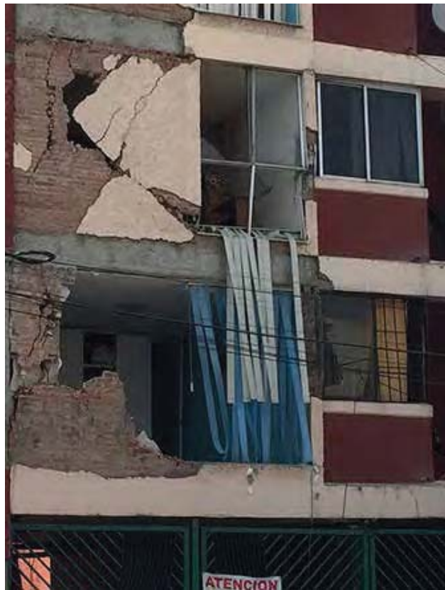
Mabel Larrechart, Registro de Grietas , Fotografías, 2017.
