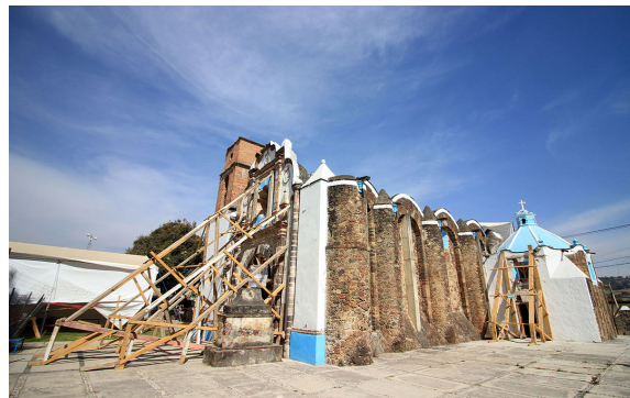
Ilustración 14.- Capilla de Santa Maria, Ocuilan, Estado de México. Afectaciones por el sismo. INAH
