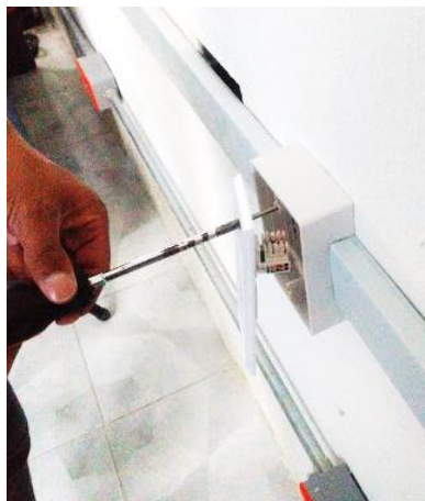
Figura 50 Fijación de tapa a registro de red.
