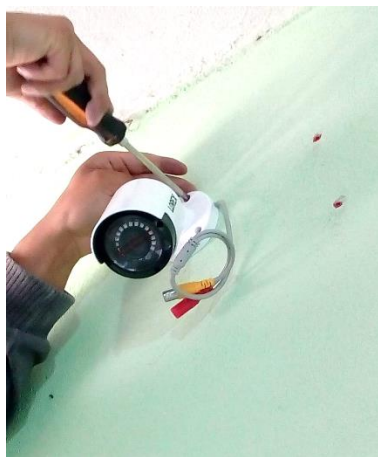
Figura 95 Instalación física de cámaras de seguridad.
