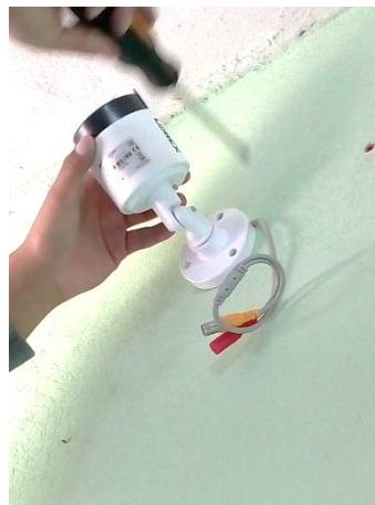
Figura 96 Instalación física de cámaras de seguridad
