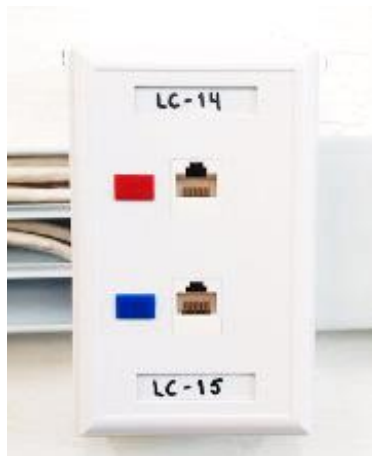
Figura 51 Registro debidamente etiquetado.
