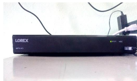
Figura 94 Instalación de DVR
