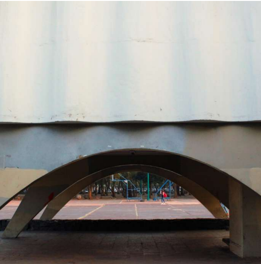
Acercamiento a los desgastes del acabado de pintura, sobre la fachada sur del laboratorio.
