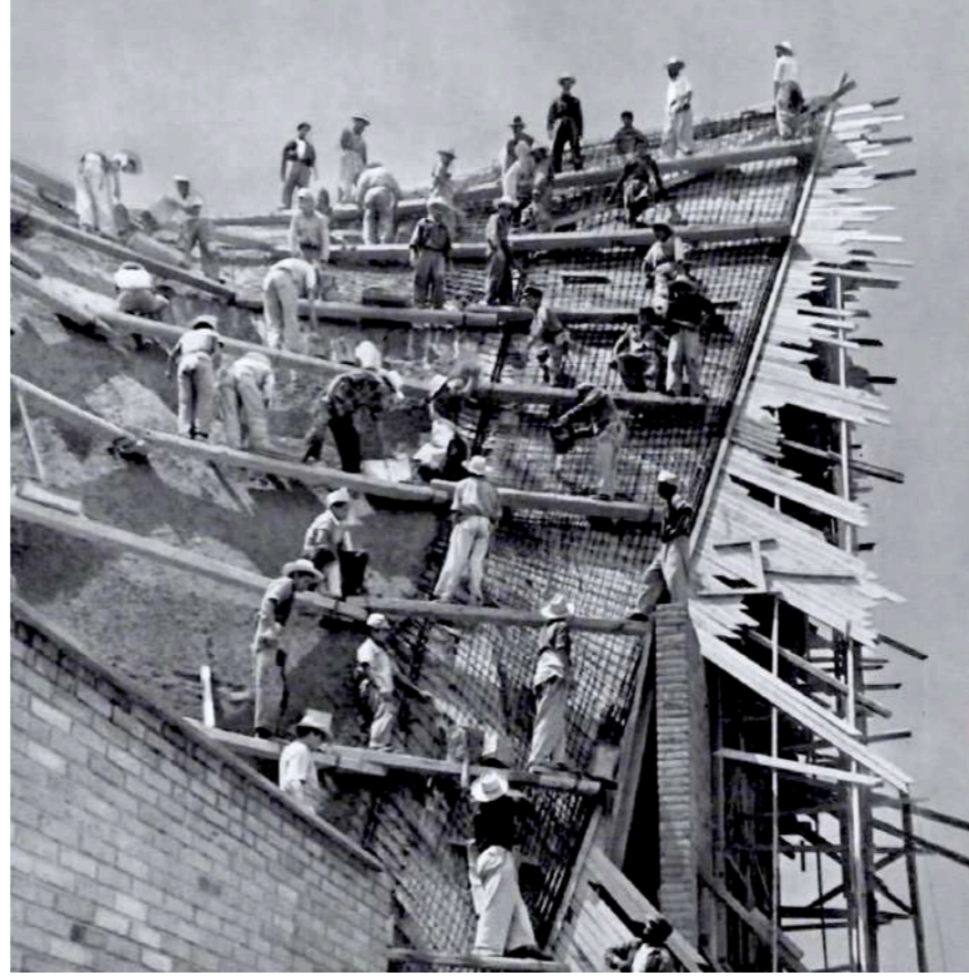
Encofrado de madera aplicado para la construcción de los hypar's de 20 metros de alto, que conforman la cubierta de la Iglesia de la Medalla Milagrosa.
