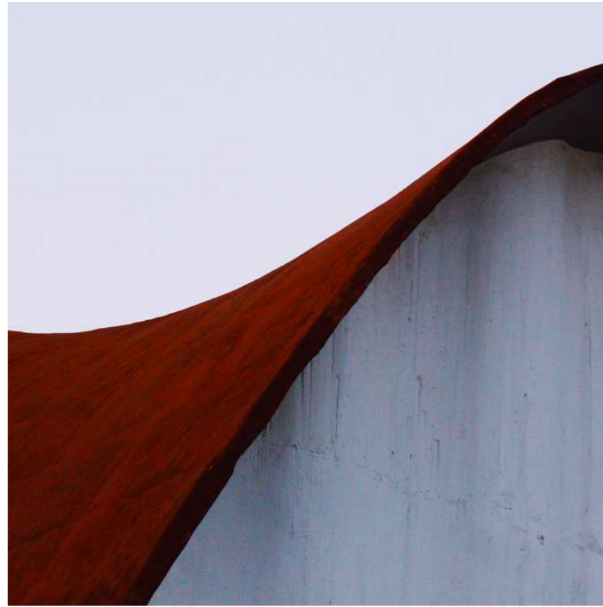
Fotografía de estado actual de la cubierta laminar del Laboratorio de Rayos Cósmicos. La toma está enfocada en una sección de la cubierta ubicada en la fachada norte.
