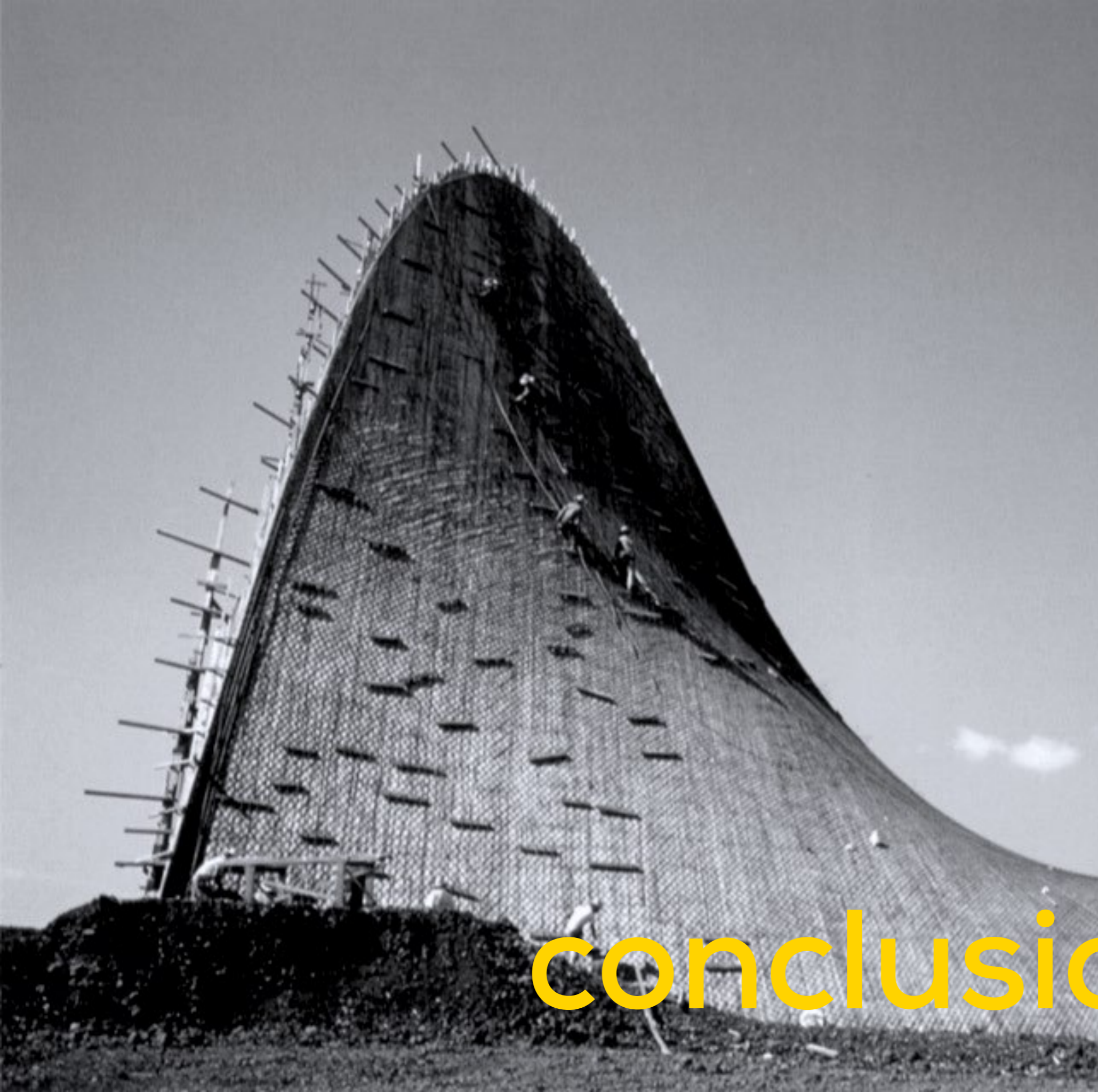
Fotografía de las obras en la Capilla abierta de Palmira en Cuernavaca, México (1958). Fuente: Princeton University Archive. Fondo fotográfico: Félix & Dorothy Candela.
