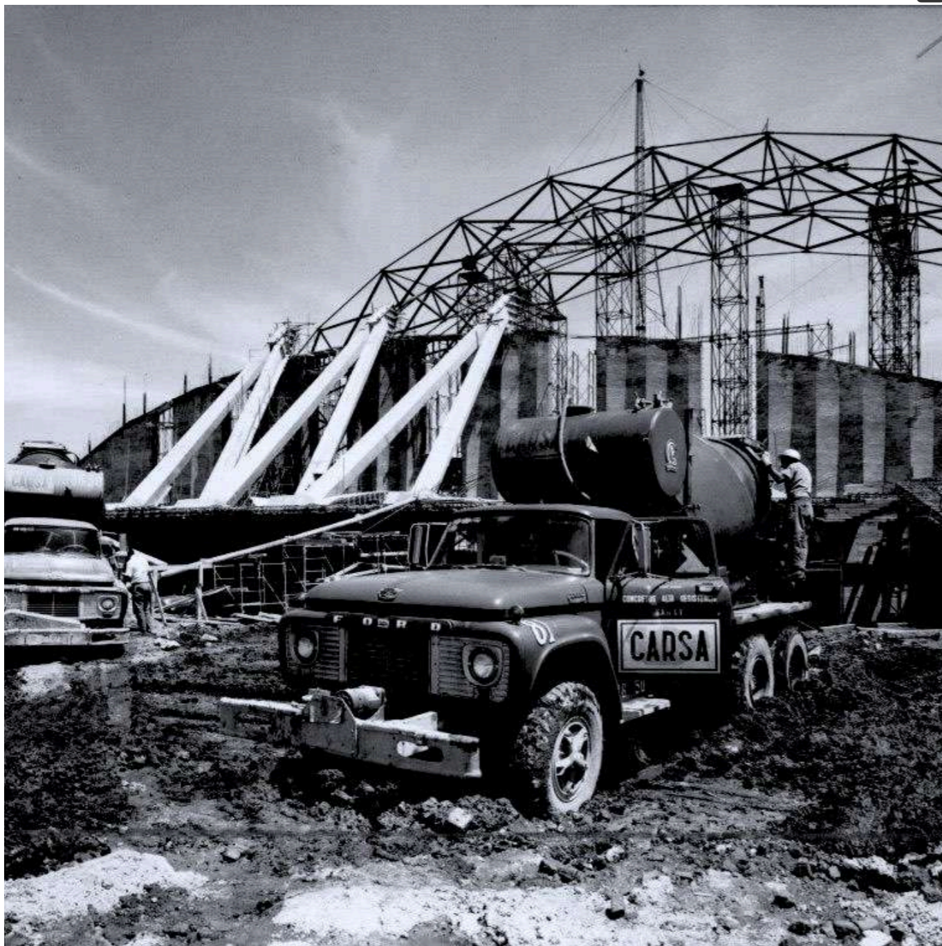
131. Fotografía de las obras en el Palacio de los Deportes, durante la colocación de la estructura de concreto armado que da soporte a la cubierta laminar. Fuente: Princeton University Archive. Fondo fotográfico: Félix & Dorothy Candela.
