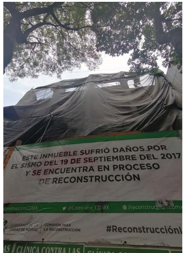
Figura 3.34 Edificio en la colonia Juárez registrado con daño muy alto (DS4) de acuerdo con la información obtenida de dictámenes y plataformas en línea. Créditos fotográficos: Vania Catalán. Marzo de 2020.
