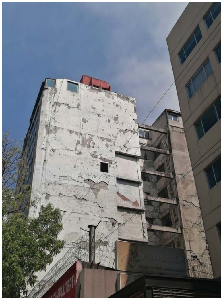
Figura A.15. Estado del edificio a dos años y medio del evento sísmico . Créditos fotográficos: Vania Catalán. Marzo de 2020.
