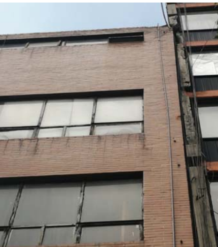
Figura A 20 Fotografía donde se observa que el edificio está recargado en su colindancia. Fachada del edificio. Créditos fotográficos: Vania Catalán. Marzo de 2020.
