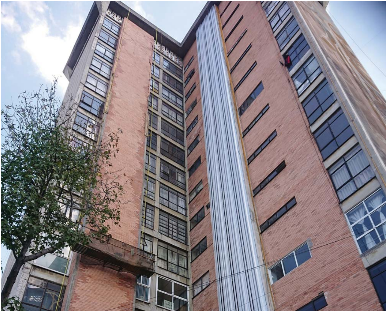
Figura A 39 Estado actual del edificio a dos años y medio del evento. Créditos fotográficos: Vania Catalán. Marzo de 2020.
