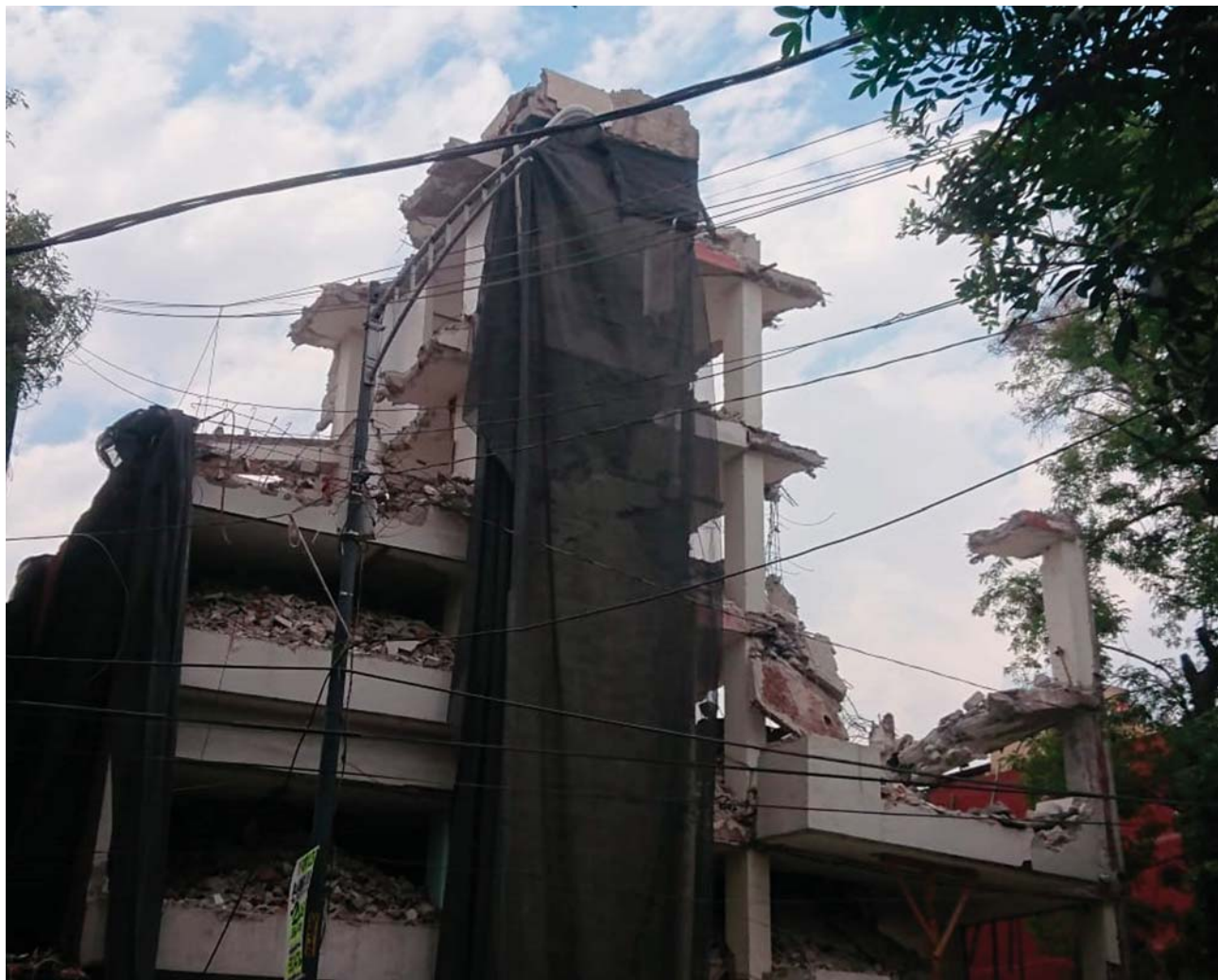
Figura A 37 Edificio en proceso de demolición. Créditos fotográficos: Vania Catalán, Marzo de 2020.
