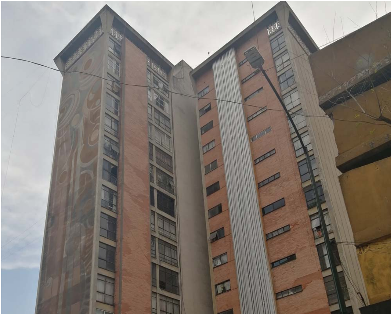
Figura A 29 Estado actual del edificio a dos años y medio del evento. Créditos fotográficos: Vania Catalán, Marzo de 2020.
