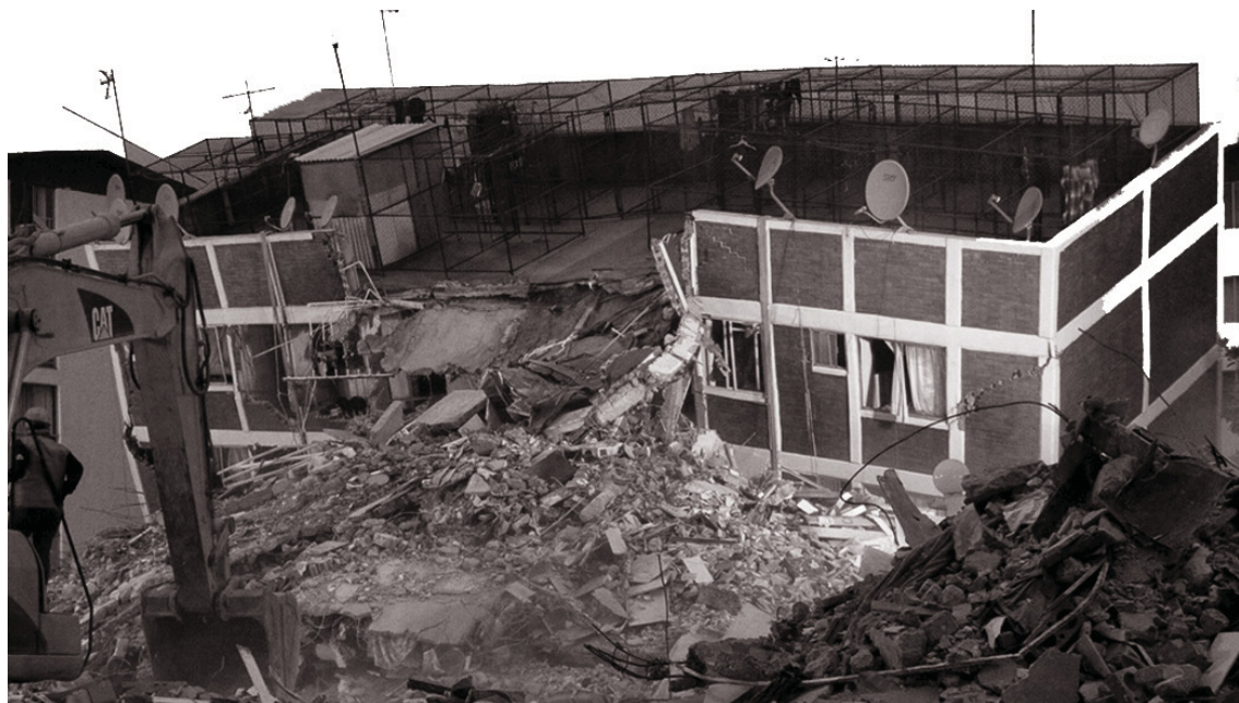
Figura 1.6 Colapso de Rancho del Arco 32, edificio multifamiliar de 6 niveles derrumbado por el sismo de 2017. Créditos fotográficos: Cuartoscuro. (Imagen obtenida de: https://bit.ly/2K8tqcP )
