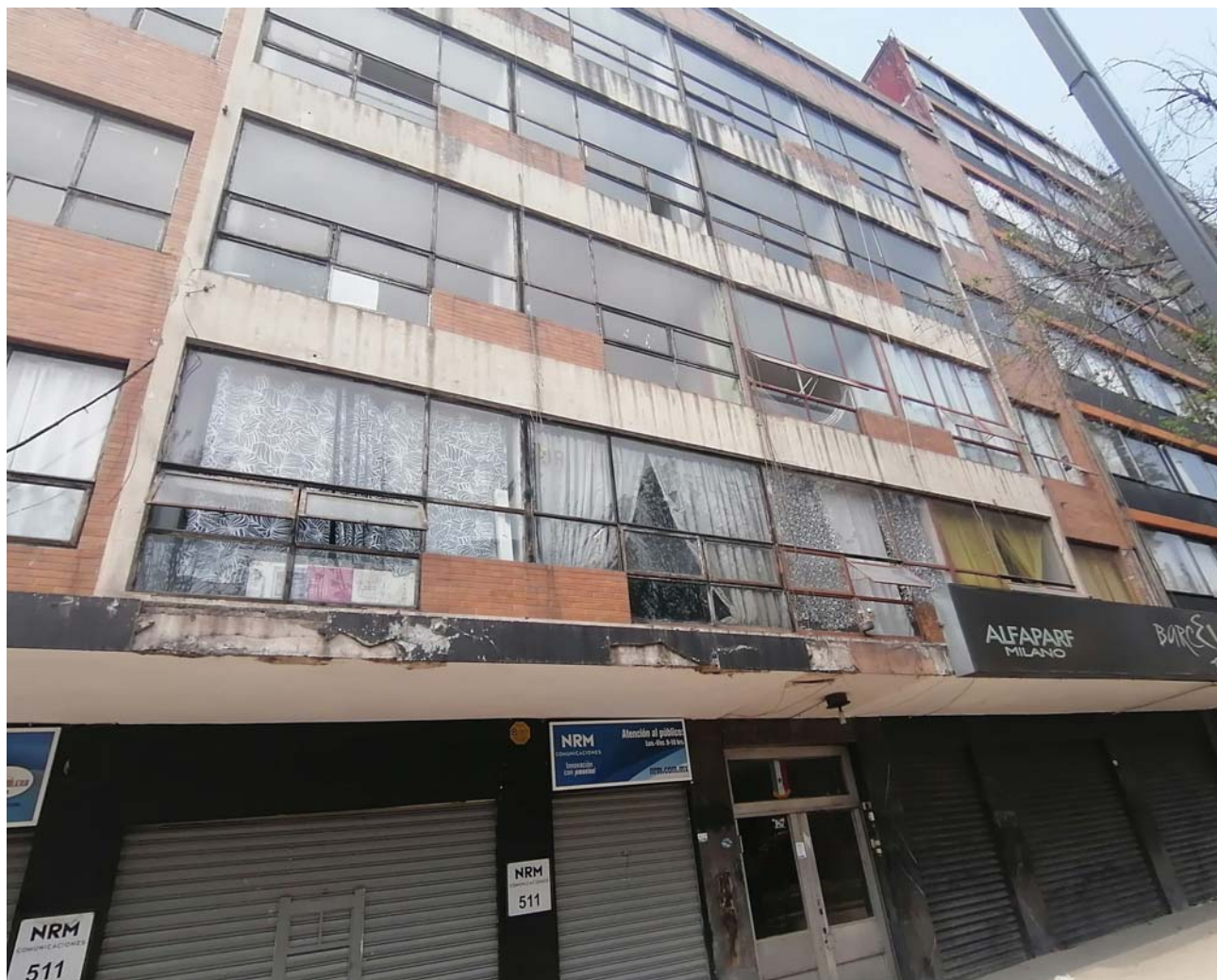
Figura A 19 Estado del edificio a dos años y medio del evento sísmico. Créditos fotográficos: Vania Catalán. Marzo de 2020.
