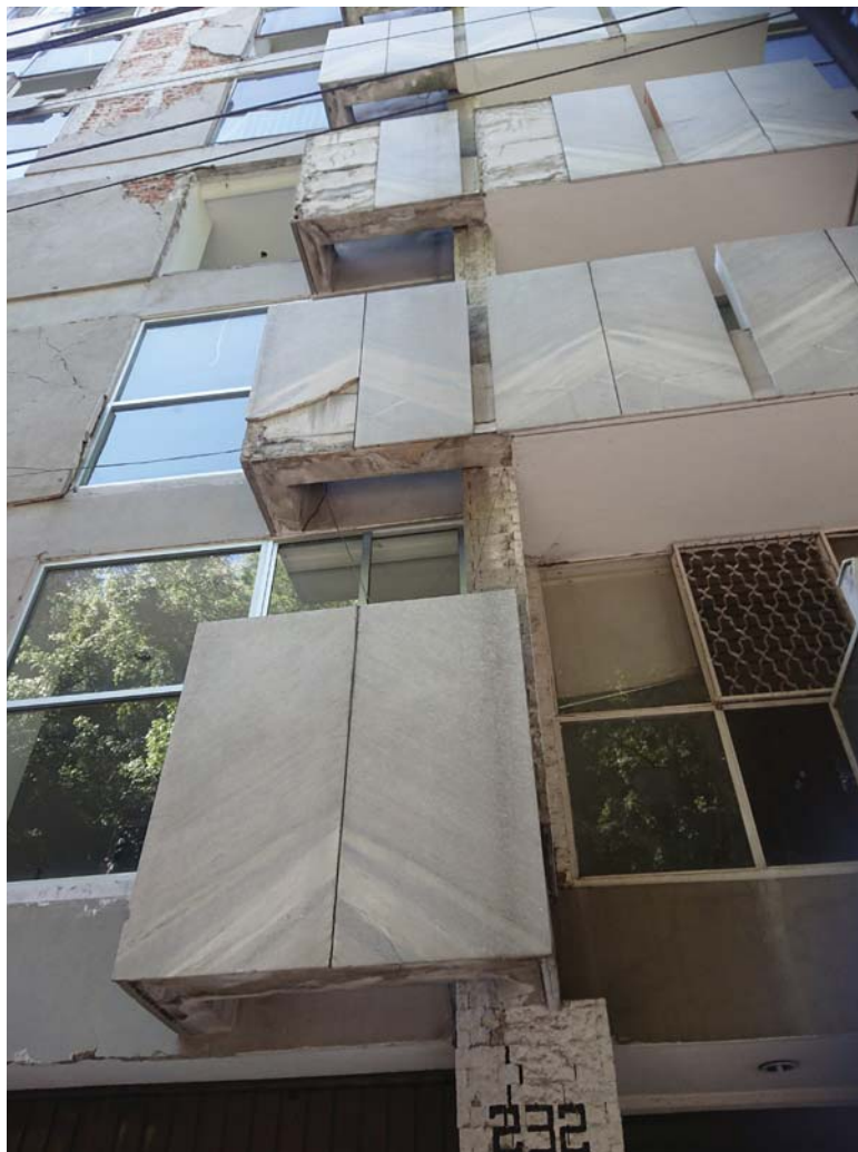
Figura A.10. Vista de los daños en fachada. Créditos fotográficos: Vania Catalán, Febrero de 2019.
