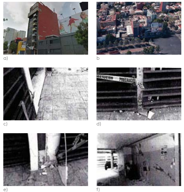
Figura A.14 Edificio considerado de alto riesgo: (a) Fachada norponiente previa al sismo (Imagen obtenida de: https://bit.ly/2ALCdOt ), (b) Vista aérea del edificio (Imagen obtenida de https://bit.ly/2ALCdOt ), (c) Daños en parte baja de columnas en fachada principal ??? (Noviembre 2017) (Imagen obtenida de https://bit.ly/2AMP9mK ), (d) Fracturas en columnas de fachada principal (Noviembre 2017) (Imagen obtenida de https://bit.ly/2AMP9mK ), (e) Daño en intersección de columna-piso en calle (Noviembre 2017) (Imagen obtenida de https://bit.ly/2AMP9mK ), (f) Desprendimiento de acabados en muros divisorios de planta baja (Noviembre 2017) (Imagen obtenida de https://bit.ly/2AMP9mK ), (g) Grietas en muros de mampostería en "X" (Noviembre 2017) (Imagen obtenida de https://bit.ly/2AMP9mK ), (h) Desprendimientos de acabados en muros de mampostería de fachadas (Noviembre 2017) (Imagen obtenida de https://bit.ly/2AMP9mK ), (i) ???, (j) ???, (k) Desprendimiento de acabados en muros de mampostería divisorios en interiores (Noviembre 2017) (Imagen obtenida de https://bit.ly/2AMP9mK ), (l) Vista interior de los departamentos posterior al sismo (Noviembre 2017) (Imagen obtenida de https://bit.ly/2AMP9mK ), (m) Daños en marcos de ventanas y desprendimiento de acabados en muros de colindancia de mampostería (Noviembre 2017) (Imagen obtenida de https://bit.ly/2AMP9mK ), (n) Daño en columna y circulación horizontal (Noviembre 2017) (Imagen obtenida de https://bit.ly/2AMP9mK ), (o) Daños en cubo de circulación vertical (Escaleras), (Noviembre 2017) (Imagen obtenida de https://bit.ly/2AMP9mK ), (p) ??? (Noviembre 2017) (Imagen obtenida de https://bit.ly/2AMP9mK )
