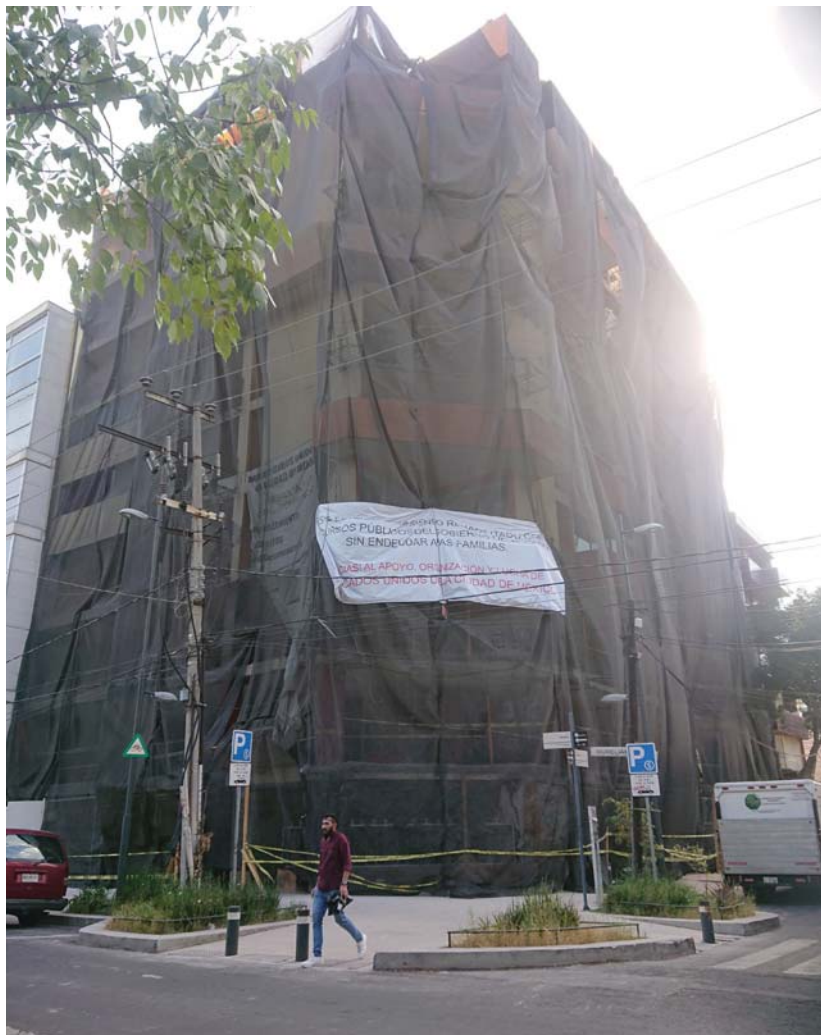
Figura A 53. Edificio en proceso de rehabilitación. Créditos fotográficos: Vania Catalán, Febrero de 2019.
