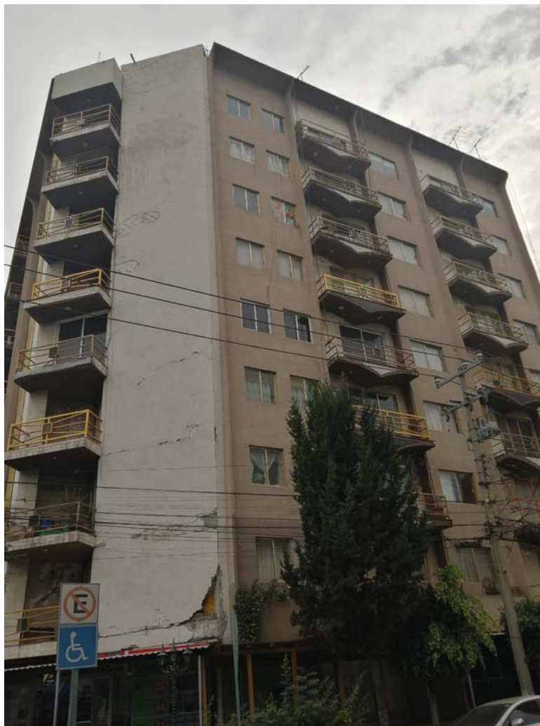
Figura A 42. Estado del edificio a dos años y medio del evento sísmico. Créditos fotográficos: Vania Catalán. Marzo de 2020.
