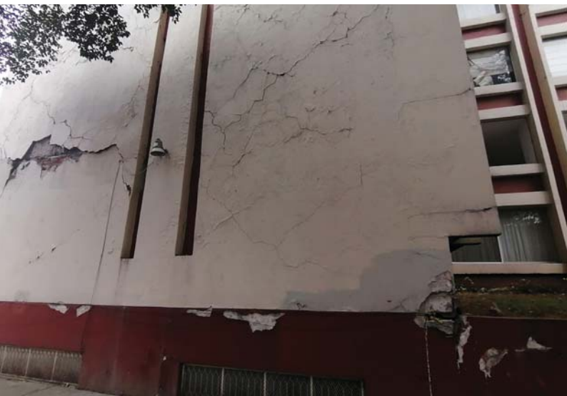
Figura A.2 Fachada del edificio habitacional Aguascalientes 12 a dos años y medio del evento sísmico. El edificio aún se encuentra deshabitado y sin comenzar un proyecto de reestructuración. Créditos fotográficos: Vania Catalán, Marzo de 2020
