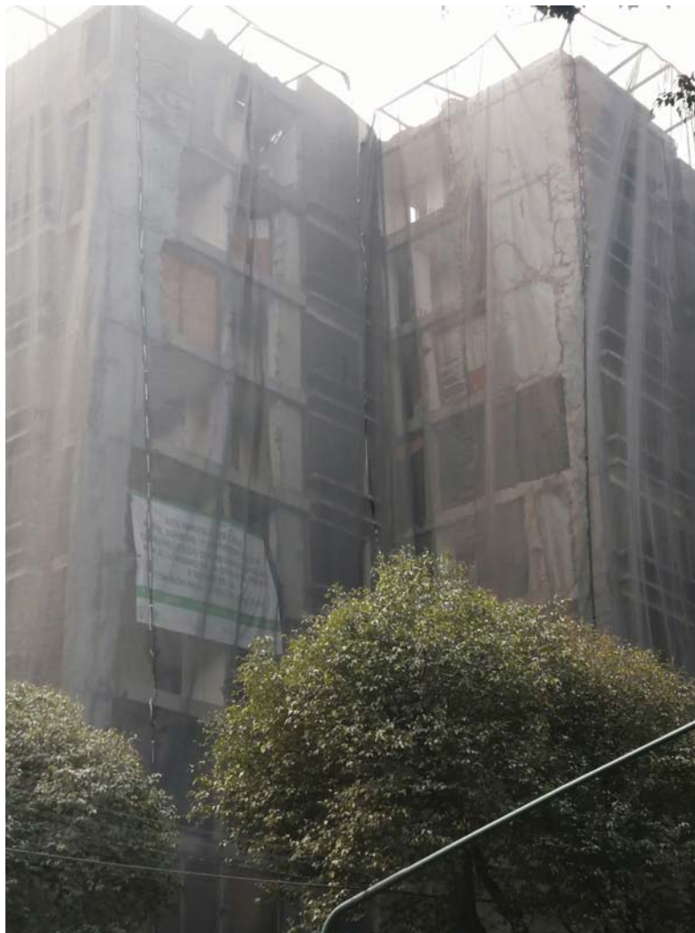
Figura A 45. Estado del edificio a dos años y medio del evento sísmico . Créditos fotográficos: Vania Catalán, Marzo de 2020.
