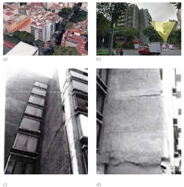
Figura A 46. Edificio considerado de alto riesgo: (a) Vista aérea del edificio (Abril 2017) (Imagen obtenida de: https://bit.ly/2FJfiaA ), (b) Fachada oriente del edificio previo al sismo (Abril 2017) (Imagen obtenida de: https://bit.ly/2AsWK8w ), (c) Grietas en muros de fachada y daños por humedad. (febrero 2018) (Imagen obtenida de: https://bit.ly/2OYQCdz ), (d) Grietas por humedad en muros de fachada (febrero 2018) (Imagen obtenida de: https://bit.ly/2OYQCdz ), (e) Pérdida de verticalidad del edificio, en el extremo superior se toca con el edificio colindante en la junta constructiva. (febrero 2018) (Imagen obtenida de: https://bit.ly/2OYQCdz ), (f) Grietas en muros de mampostería y daños en columnas (febrero 2018) (Imagen obtenida de: https://bit.ly/2OYQCdz ), (g) Fallo de columna que dejó el acero expuesto con las varillas flexionadas. (febrero 2018) (Imagen obtenida de: https://bit.ly/2OYQCdz ), (h) Vista de varillas flexionadas y que perdieron continuidad. (febrero 2018) (Imagen obtenida de: https://bit.ly/2OYQCdz ), (i) Grietas en muro de block y daño estructural en un nodo entre columna y trabe en la zona de rampa. (febrero 2018) (Imagen obtenida de: https://bit.ly/2OYQCdz ), (j) Desprendimiento de acabados en muros de block (febrero 2018) (Imagen obtenida de: https://bit.ly/2OYQCdz ), (k) Daños en sótano y casetones de losa aligerada. (febrero 2018) (Imagen obtenida de: https://bit.ly/2OYQCdz )
