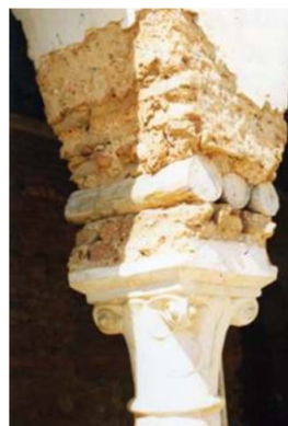
Fig. II.1.9 Aislamiento sísmico compuesto por troncos de madera entre la columna y la arcada. (Genatios, C 2016).
