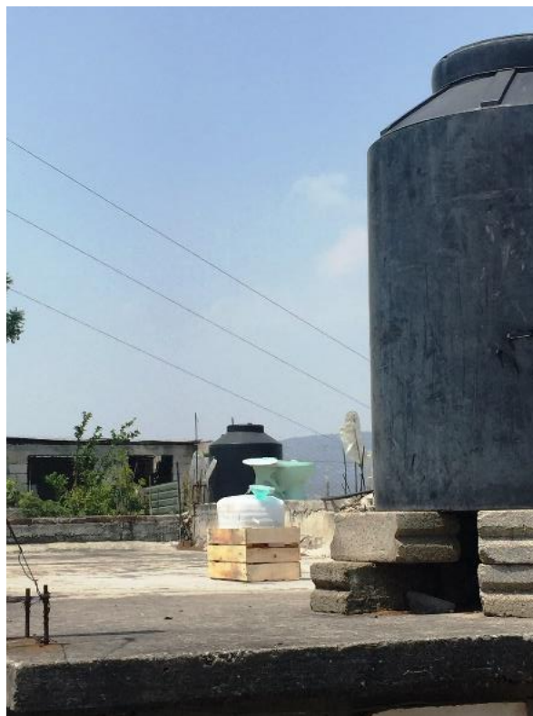
Figura 21 Colocación del recolector de lluvia en la casa del Sr. Raymundo García Jiménez, en Tula de Allende, Hgo., el 24 de mayo de 2019. (GIMA, 2019)
