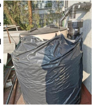
Fotografía 6. Tanque de almacenamiento
