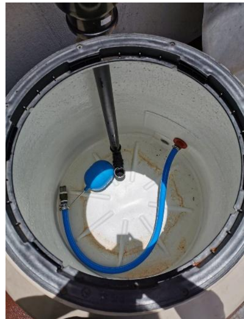
Fotografía 7. Tanque de almacenamiento limpio
