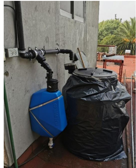
Fotografía 2. Tanque de almacenamiento
