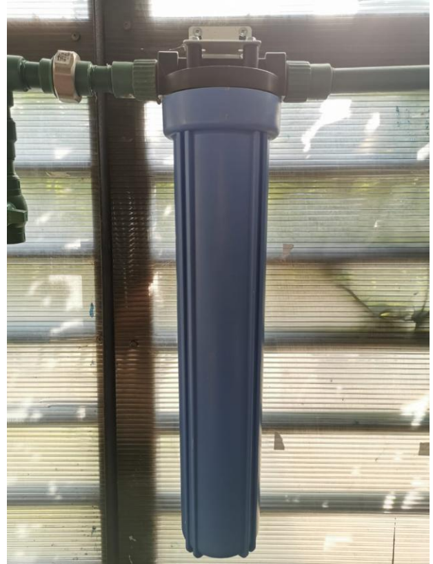
Foto 8. Filtro de carbón activado.
