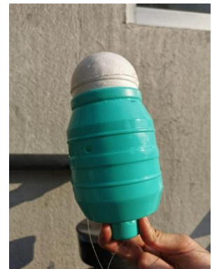
Fotografía 6. Dosificador de cloro
