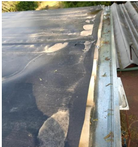
Foto 11. Área de captación meses después de su instalación.
