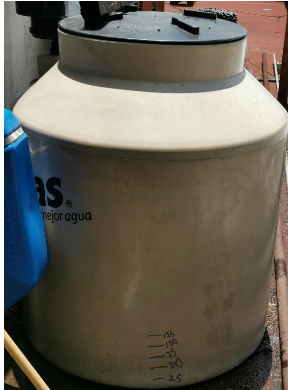
Foto 5. Tanque de almacenamiento.
