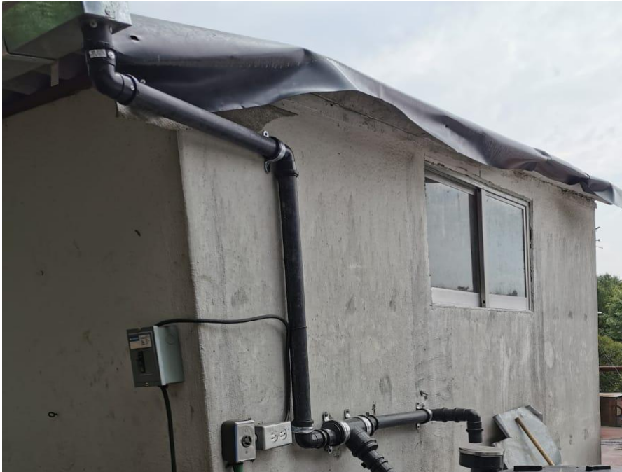
Foto 2. Tubería de PVC.
