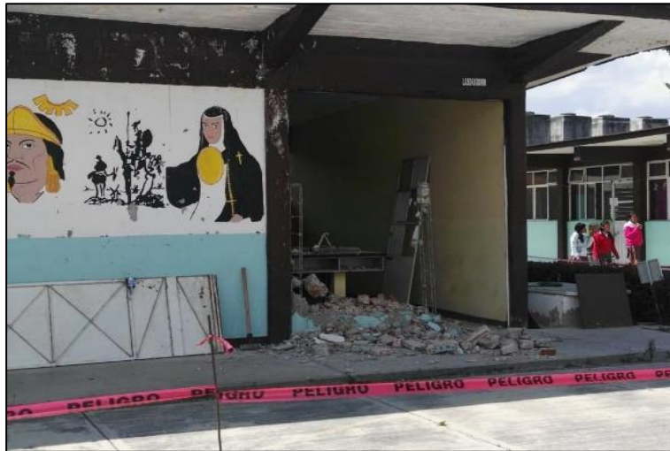
Figura 4.29. Estructuras de la secundaria afectadas por el sismo de 7 de septiembre 2017
