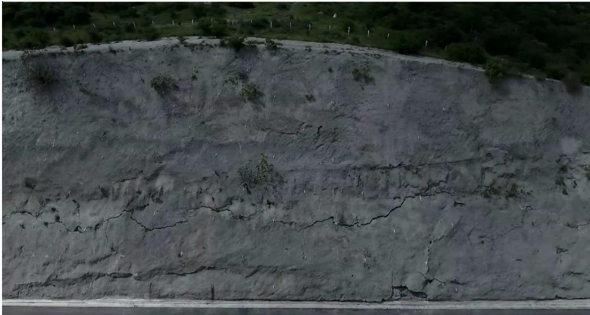
Figura 4.36. Presencia de severas grietas y desprendimiento de concreto lanzado en la zona central del talud (SCT, 2016-B).
