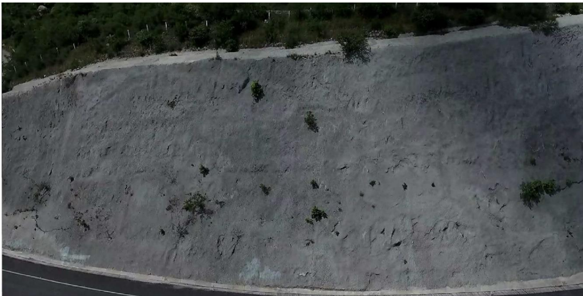
Figura 4.35. Presencia de grietas e indicadores cinemáticos que evidencian los daños en el talud (SCT, 2016-B).
