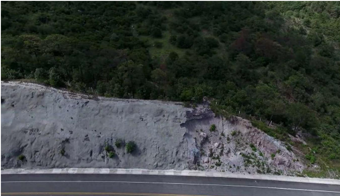
Figura 4.37. Colapso parcial del talud (SCT, 2016-B).
