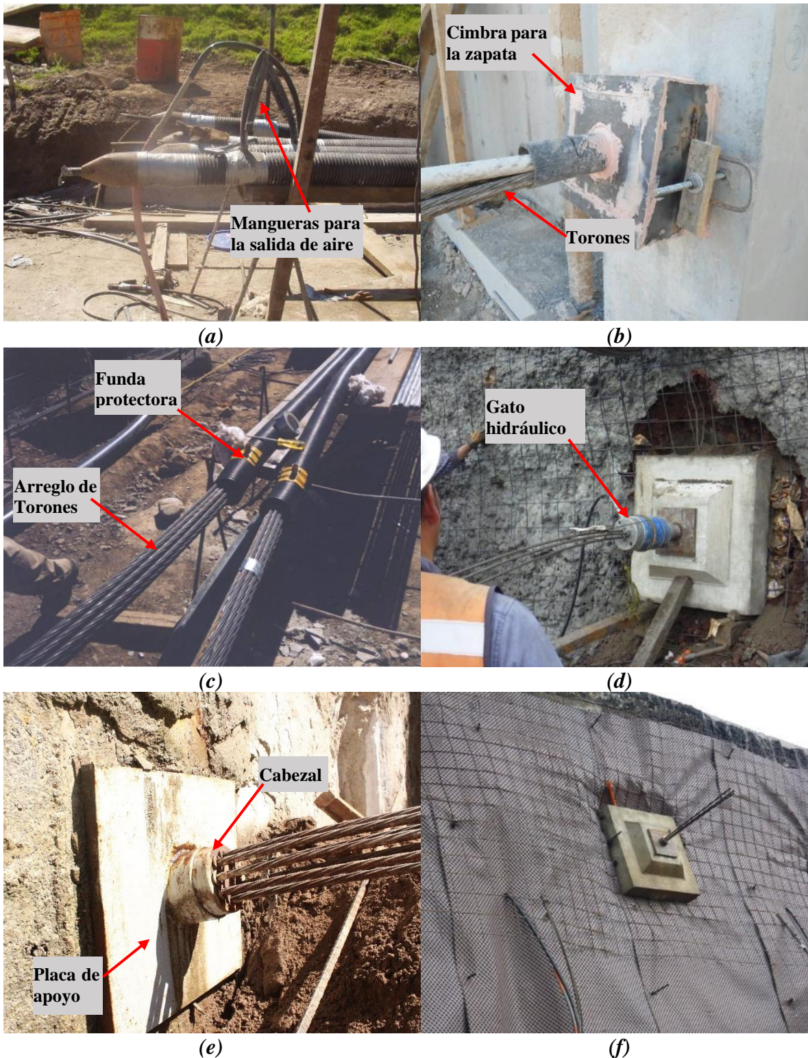
Figura 2.4. Detalles de la instalación de un sistema de anclaje: (a) habilitado de las mangueras para salida de aire, (b) zapata y torones, (c) arreglo de torones, (d) tensado del sistema de anclaje, (e) tensado terminado, (f) trabajo finalizado (Medel, 2019)
