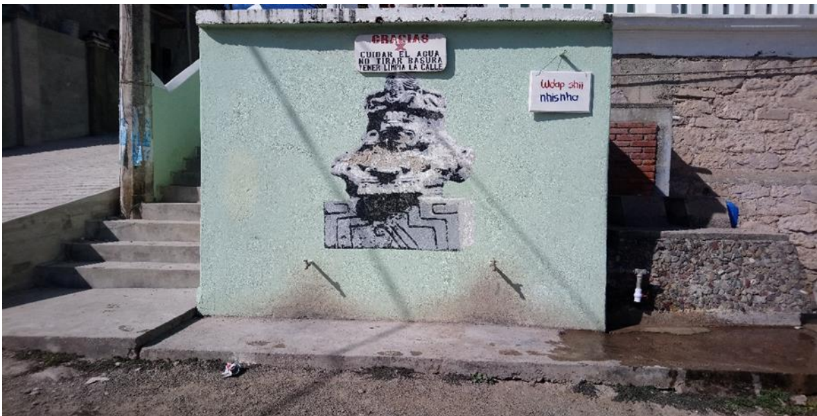
Figura 2.21 Hidrante, San Francisco Cajonos, Oaxaca.
