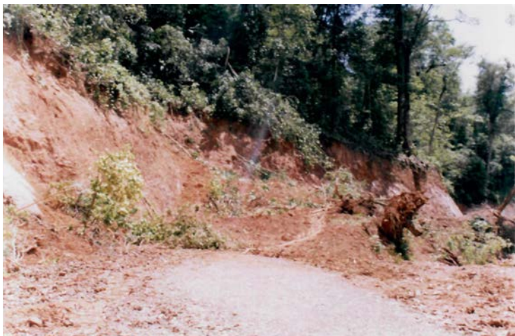
IMAGEN 26. DERRUMBE SOBRE EL TRAMO CARRETERO LOVANI - PETLAPA - VILLA ALTA, 2009. FOTOGRAFÍA: LMZ
