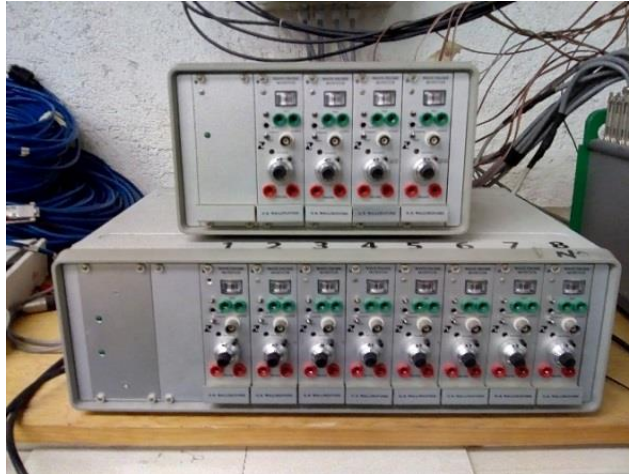
Figura 23 Gabinetes para conectar los sensores de nivel.
