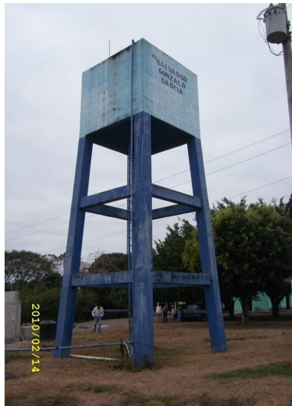
Tanque elevado capacidad 27,000 litros Fuente: Gabriel A. Pérez
