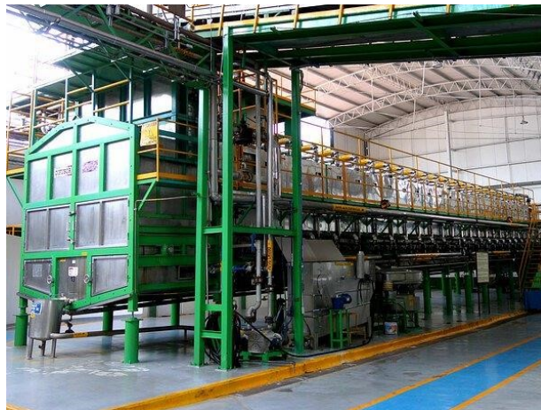
Imagen 5.11 Extracción por difusor
