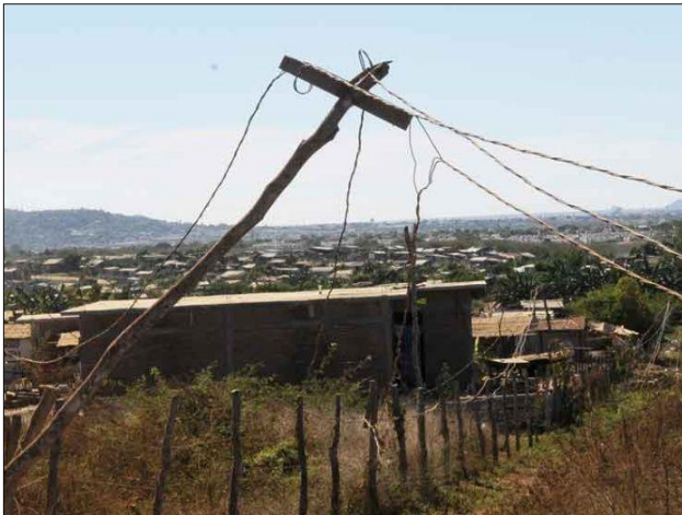
Imagen 16: Toma colectiva a la red de energía eléctrica.
