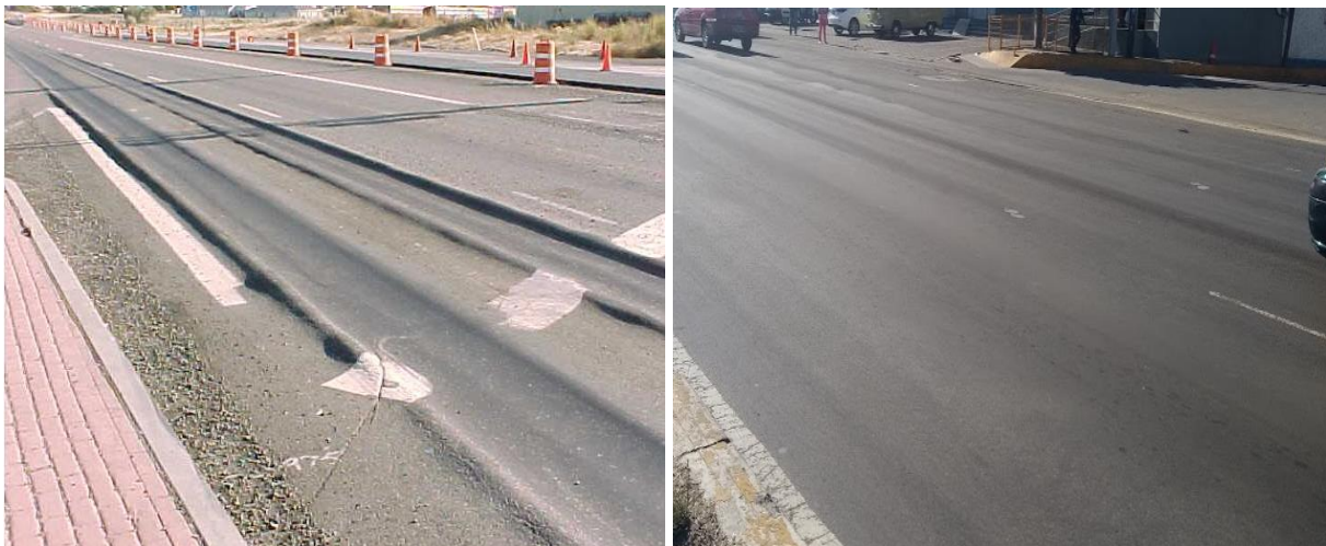
Figura 2.5.1. Ejemplo de roderas en carpetas asfálticas
