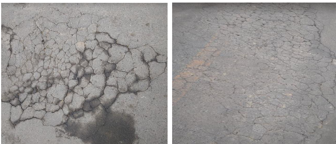
Figura 2.5.2. Ejemplo del fenómeno denominado “Piel de cocodrilo” en carpetas asfálticas
