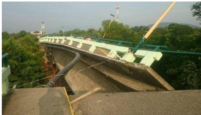
Fig. 4 Fallas en puente causado por los daños debidos al sismo del 7 de septiembre de Chiapas y colapso por el sismo del 23 de septiembre de Oaxaca(Libertad Bajo Palabra, 2017)
