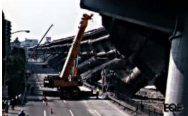
Fig. 2 Fallas en puente causado por el sismo de Kobe 1995 (Oller, Barbat, & Soberón, 2000)
