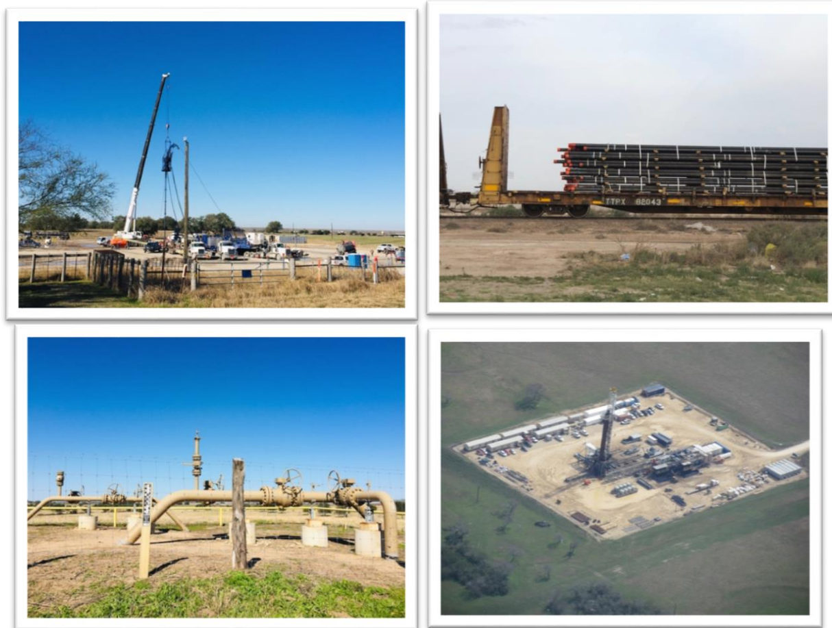
Ilustración 5. Equipo de perforación, tuberías y válvulas
