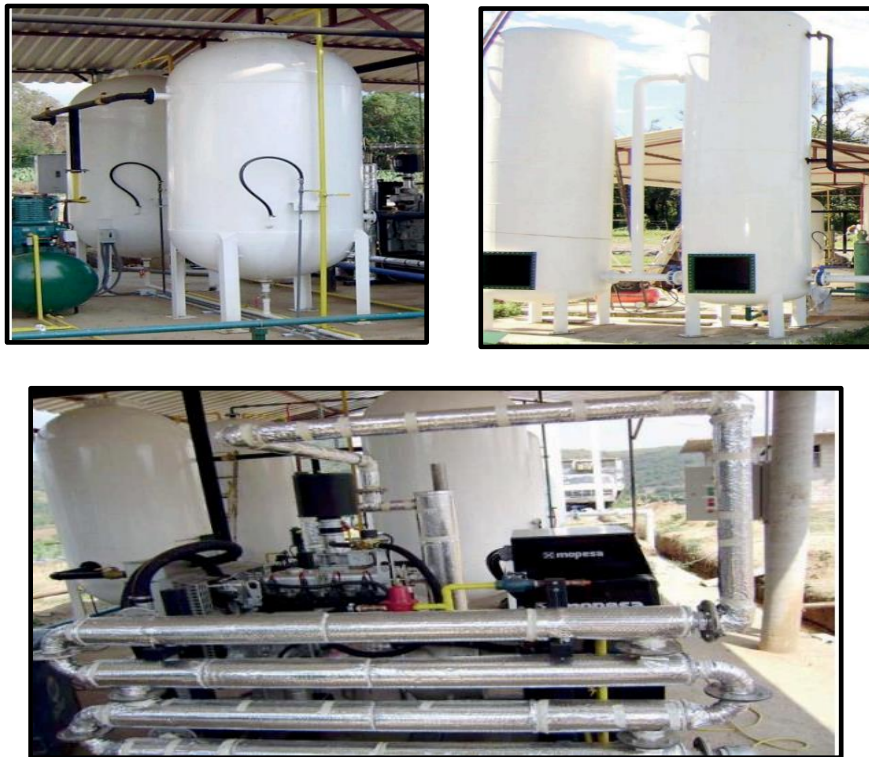
Figura 4.8. Purificador de ácido sulfhídrico, tanques de aireamiento y recuperación de biogás e intercambiadores de calor agua-agua.
