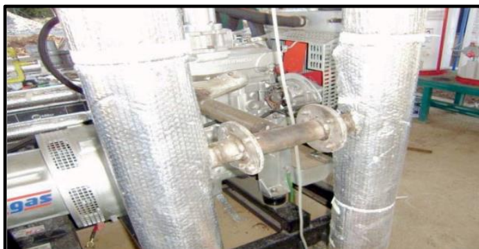
Figura 4.9. Intercambiadores de calor agua-gas y el compresor de aire.
