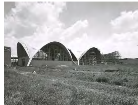
Fig. 33 1958-71 PLANTA BACARDÍ CUATITLAN, EDOMEX Arq. SACMAG e Ing. Luis Torres Landa -Planta embotelladora -almacenes -comedor -estacionamiento -almacenes de añejamiento
