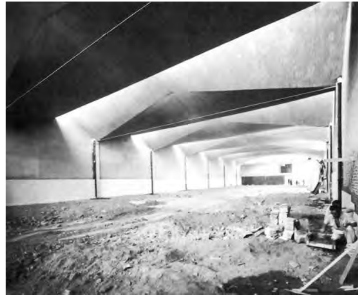
Fig. 71 1957 Vista interior durante la construcción, Fábrica de Dulces el León, Norte 45 611, Vallejo Industrial, Azcapotzalco, Ciudad de México Ordoñez y Candela
