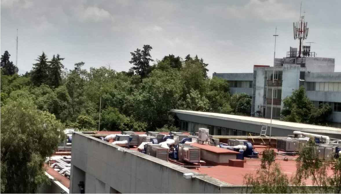
Figura 64 Edificio E con una correcta protección por pararrayos y puntas colectoras (método de esfera rodante).
