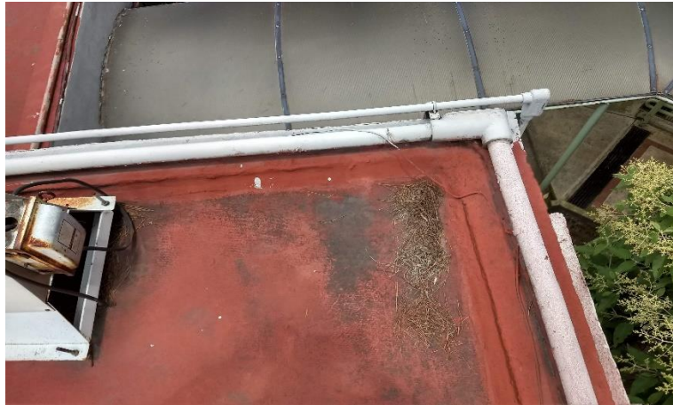
Figura 49 Ejemplo de correcta separación entre SPCDEE (tubería gruesa) y SPCDEA (tubería delgada).
