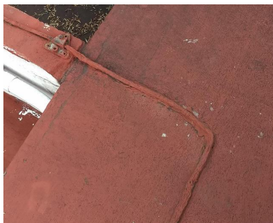
Figura 57 Ejemplo de ruta inadecuada en bajante de pararrayos (no es la ruta más directa y sin codos).
