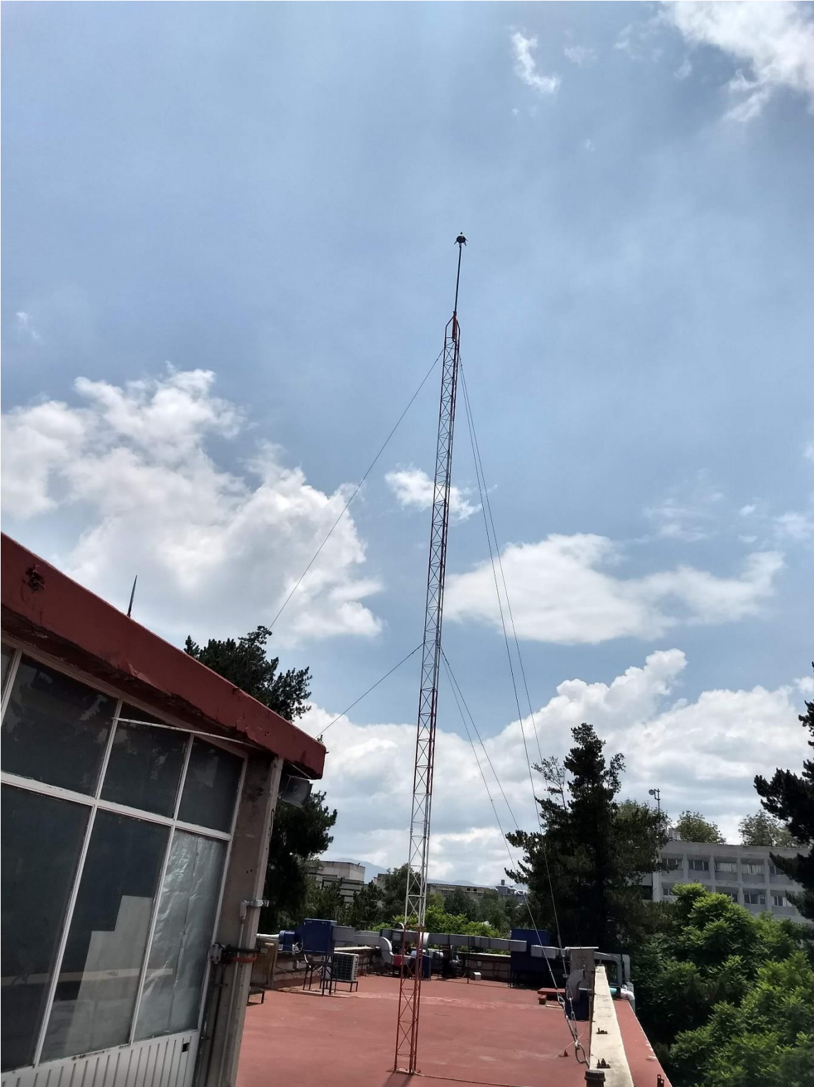
Figura 66 Pararrayos más reciente instalado, con su sistema de sujeción que impide volcaduras o inclinaciones edificio C.
