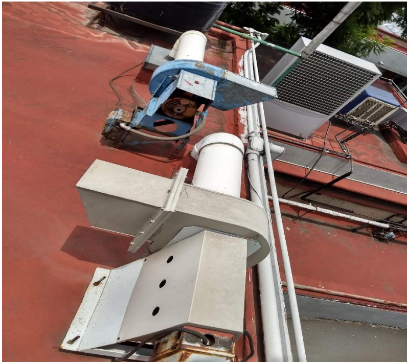
Figura 47 Ejemplo de correcta interconexión entre todos los equipos del SPCDEE, es destacable que se interconectan entre todos ellos y se hallan confinados a tuberías (aunque estas no están señalizadas).
