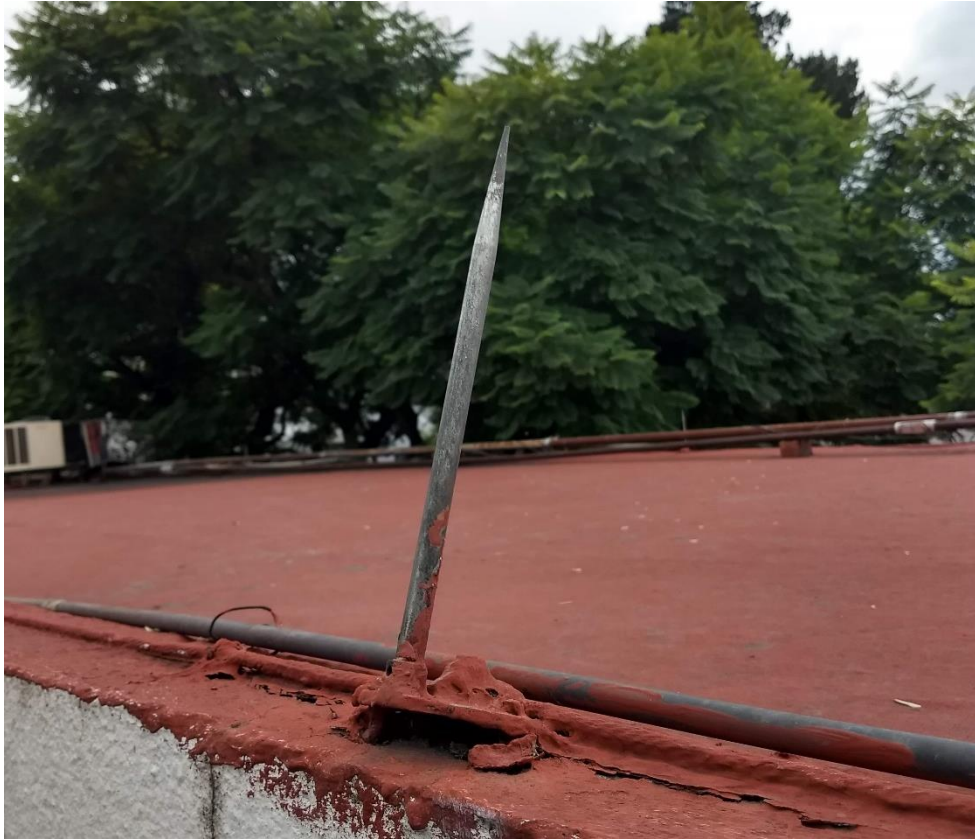
Figura 58 Evidencia de punta interceptora en buen estado, aunque la bajante no lo esté.
