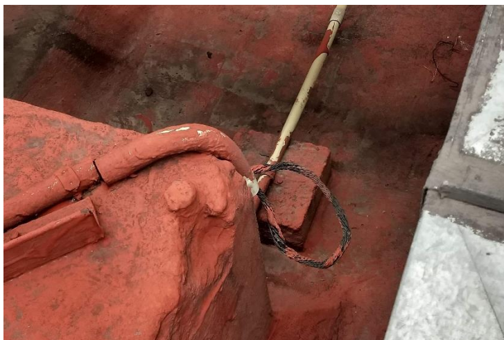
Figura 69 Mal estado de conductor de bajada, así como el hecho de estar descubierto y en ángulo menor a 90 grados.
