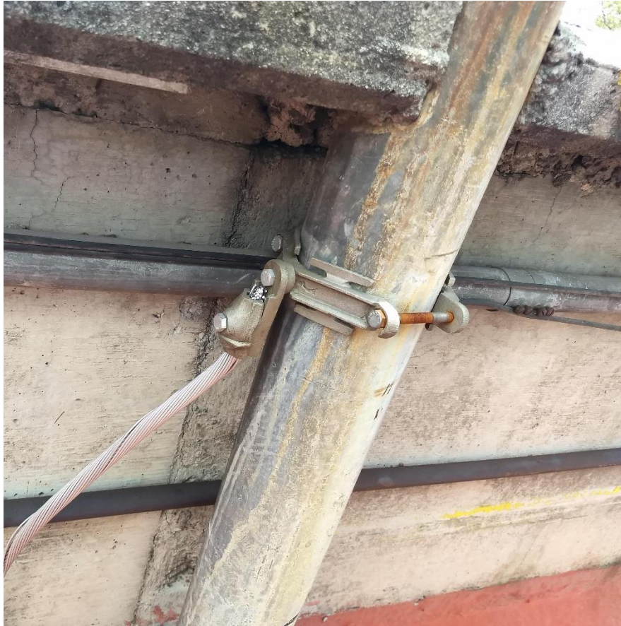
Figura 62 Ejemplo de interconexión entre SPCDEA y una tubería expuesta a descargas atmosféricas, así como generadora de gran cantidad de electricidad estática 2 de 2. Se aprecia adecuada cobertura del conductor de bajada.
