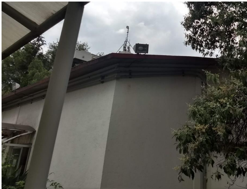
Figura 68 Edificio nuevo LUME, no incluido en arreglo del centro de trabajo, y sin protección contra descargas estáticas atmosféricas.
