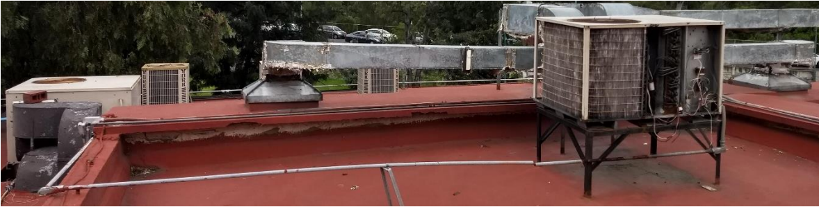
Figura 48 Ejemplo de equipo interconectado al SPCDEE correctamente.
