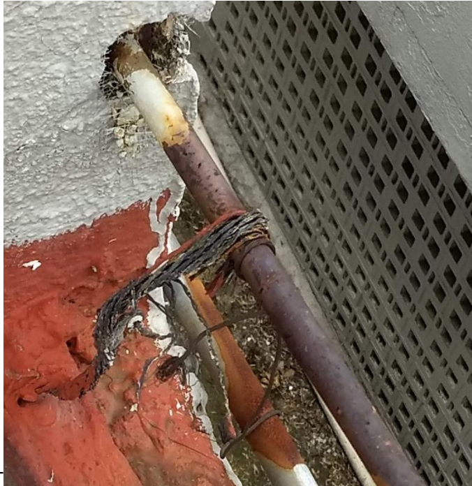
Figura 46 Ejemplo de interconexión incorrecta del SPCDEA con la tubería del edificio A. Aunque es válido para la interconexión del SPCDEE Y SPCDEA, la interconexión debe asegurar la unión eléctrica (soldadura o junta).
