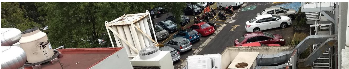
Figura 55 Ejemplos de contenedores protegidos contra descargas atmosféricas: en el lado izquierdo, un contenedor de agua que está interconectado al sistema de tierras físicas mediante tuberías y en el lado derecho un rack de cilindros de acero cerrados e interconectados a la tierra física mediante cimentación. Este último incluso cuenta con punta receptora.
