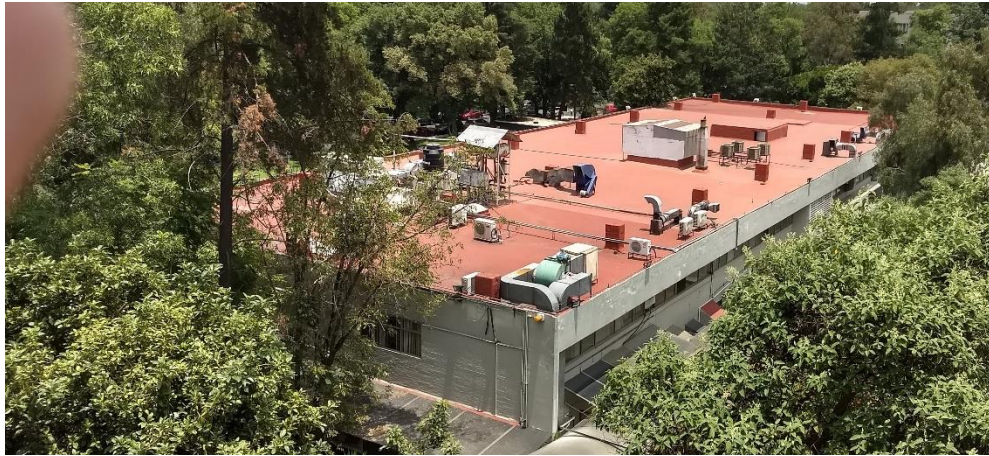
Figura 65 Edificio T, taller, sin protección alguna contra descargas atmosféricas, a pesar de contener sustancias combustibles en cantidades moderadas..
