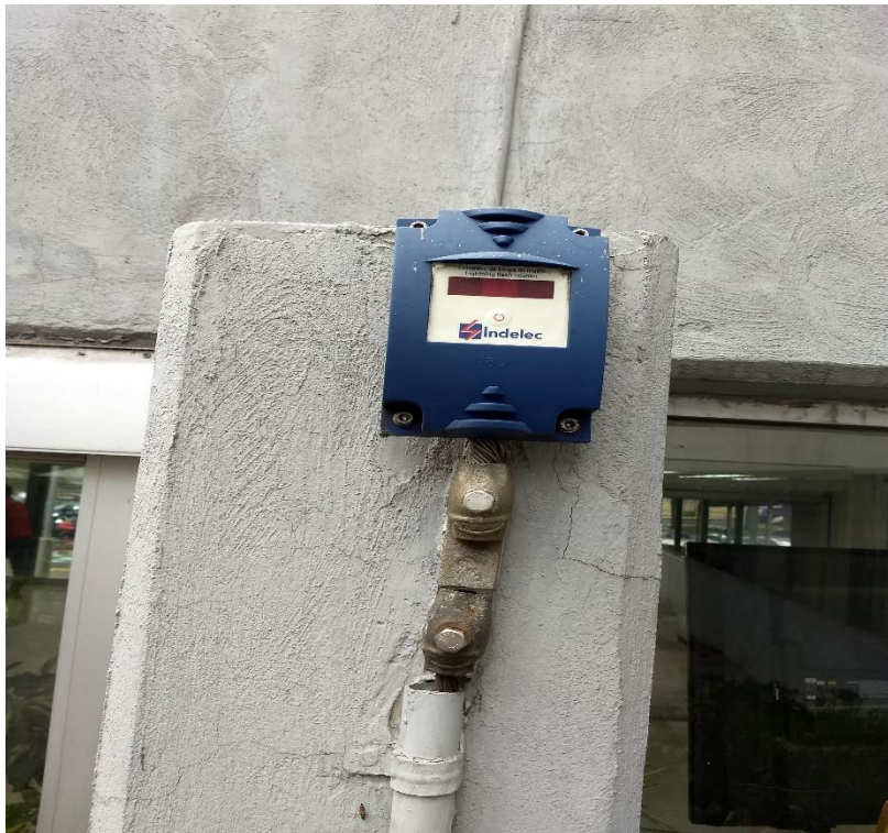
Figura 59 Evidencia de correcta interconexión con medidor de tensión, canalización adecuada pero sin identificar, y ruta más corta y directa posible de bajante de pararrayos Edificio A.
