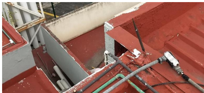
Figura 54 Ejemplo de puntas interceptoras de SPCDEA, se evidencia que no están canalizadas las bajantes, y que falta mantenimiento en el SPCDEA.
