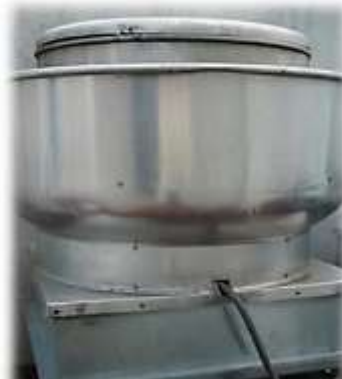
Ilustración 10. Campana de extracción de la parrilla
