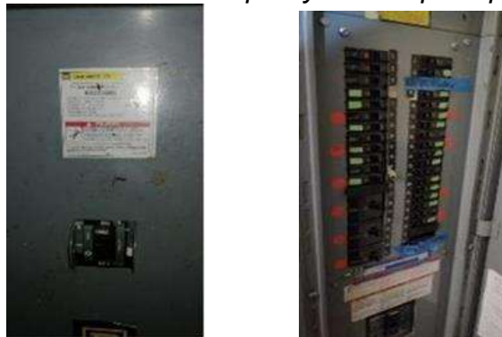
Ilustración 1. Interruptor y tablero principal
