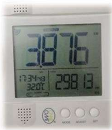
Ilustración 20. Monitor de energía, medición de equipo de aire acondicionado número 3
