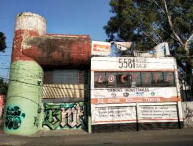
Fotografía 1. Inmueble en abandono en el tramo Atlalilco.
