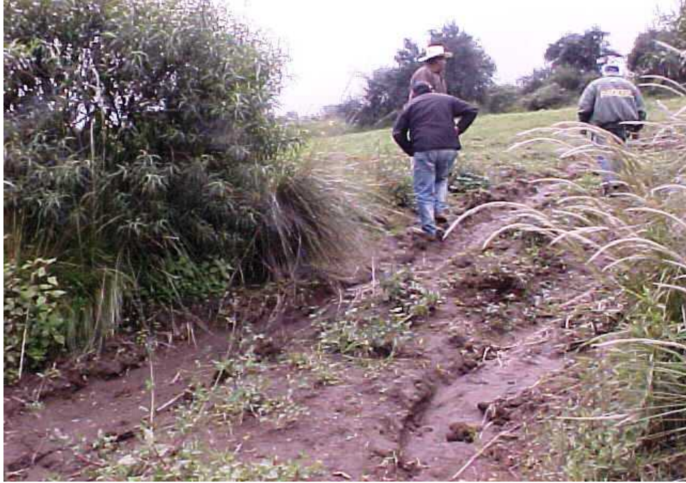
Figura No. 12 Bordo deteriorado con erosión hídrica evidente.
