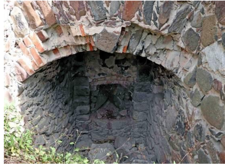
Imagen 100. Detalle, boca de alimentación, 2019.
