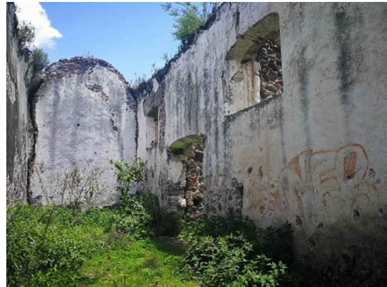
Imagen 65. ②. Vista del interior del almacén, pérdida total de cubierta abovedada. 2018.
