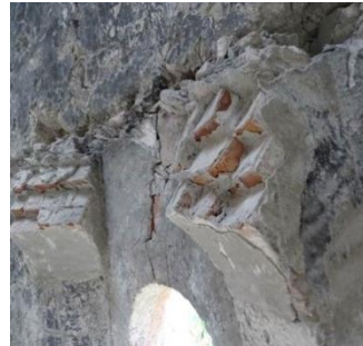
Imagen 158. Detalle (salmer) arranque de arco.
