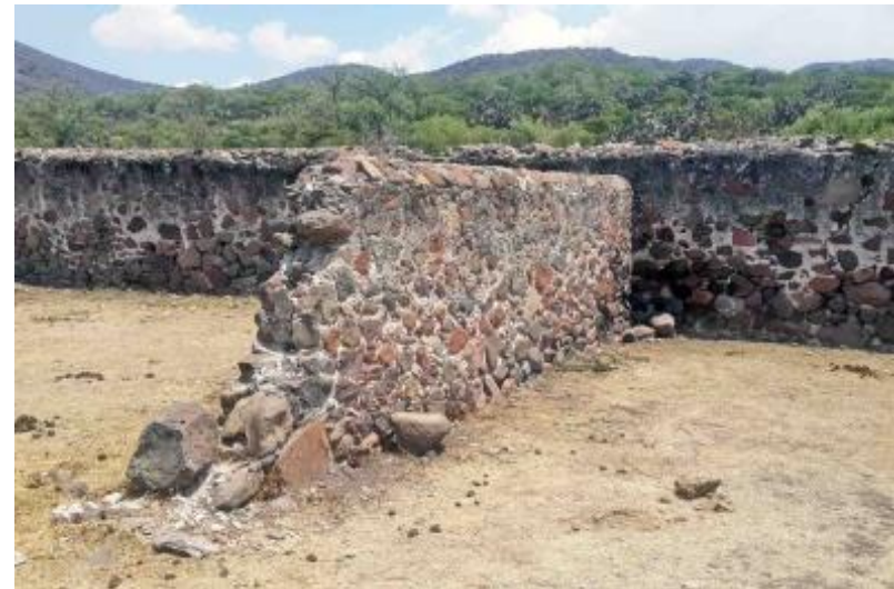
Imagen 57. Detalle de muro de corral, construido con mampostería de mayor tamaño decreciendo en la parte superior y coronado con un boleado. 2017.
