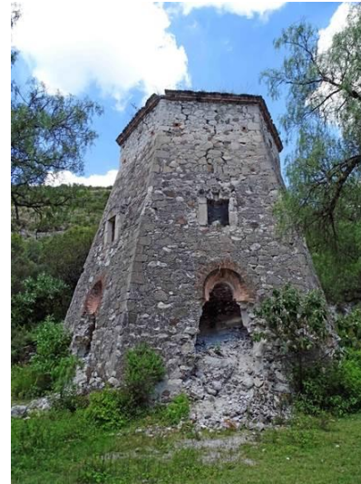
Imagen 153. Estado actual del Horno Rumford de la Hacienda Calera de Apaxco, vista del lado oriente, el acceso ha quedado obstaculizado por el derrumbe del interior.
