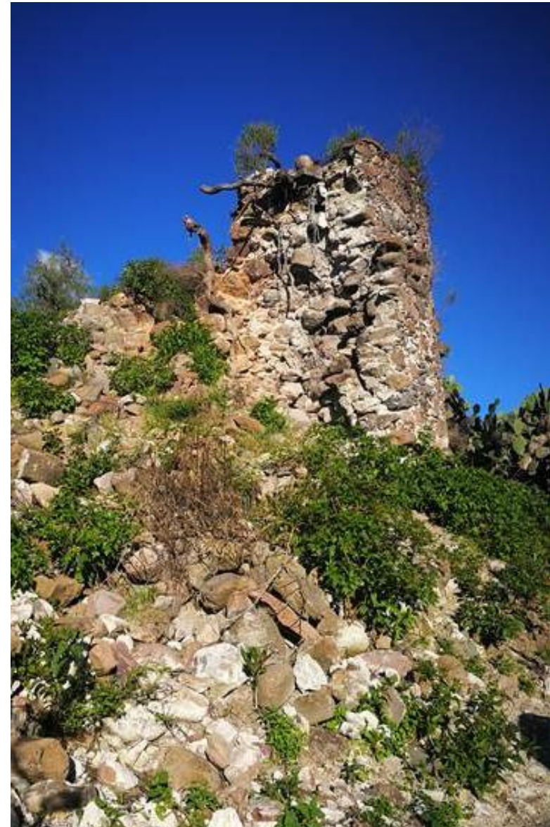
Imagen 110. Detalle de muros del H-3. Fábrica expuesta después de colapsar parte de sus muros. 2018.
